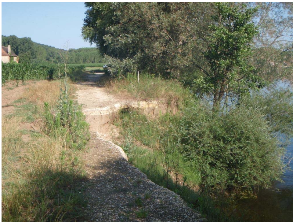
Illustration 18 : Erosion de berge sur la commune de Siorac
