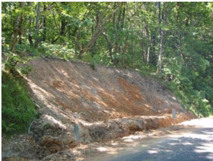
Illustration 20 : Glissement de terrain dans le talus d'une route sur la commune de Plazac
