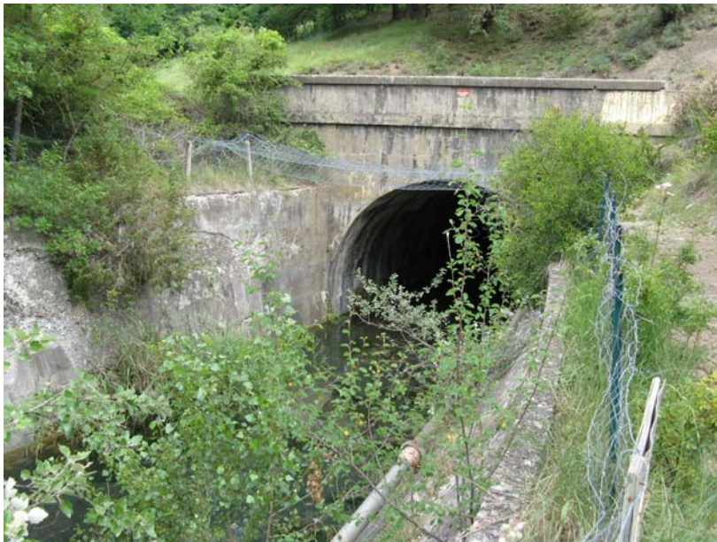
Illustration 24- Ancien canal EDF - commune d'Upaix- PACAA1000664
