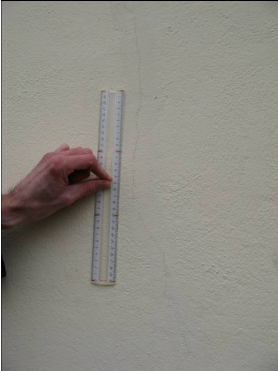
Photo 28 - Fissure observée sur la chapelle.
