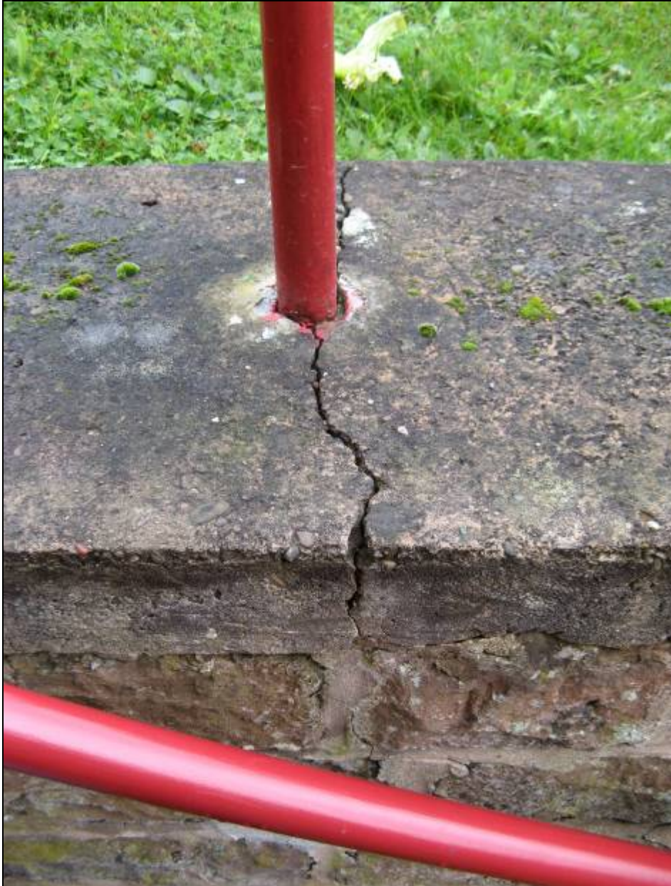
Photo 36 - Fissure du muret de l'escalier descendant de la terrasse de la mairie (parcelle 96).
