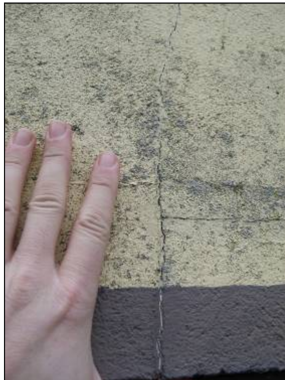
Photo 4 - Fissure sur le bâtiment du côté est jouxtant la terrasse, derrière la maison de M. Sahling.
