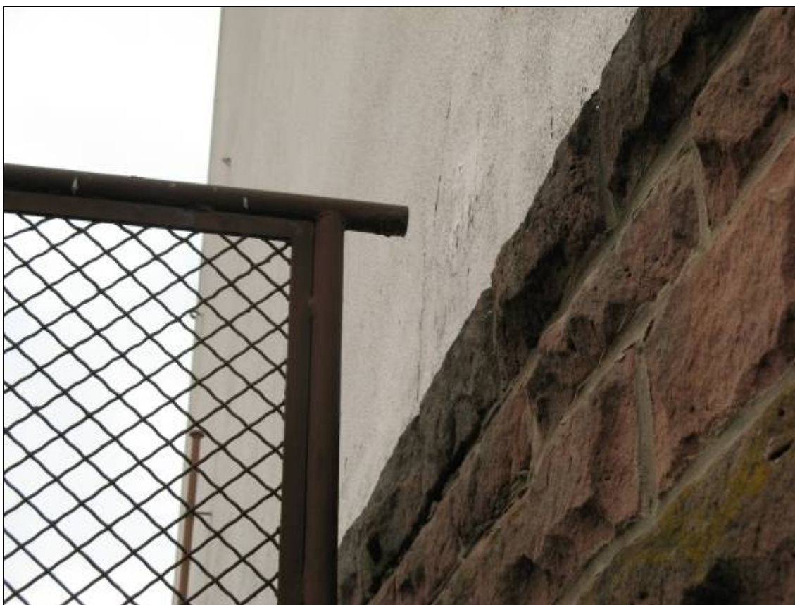
Photo 32 - Ecartement de rambarde de 75 mm par rapport au mur du côté est du bâtiment de la mairie, depuis 20 ans.
