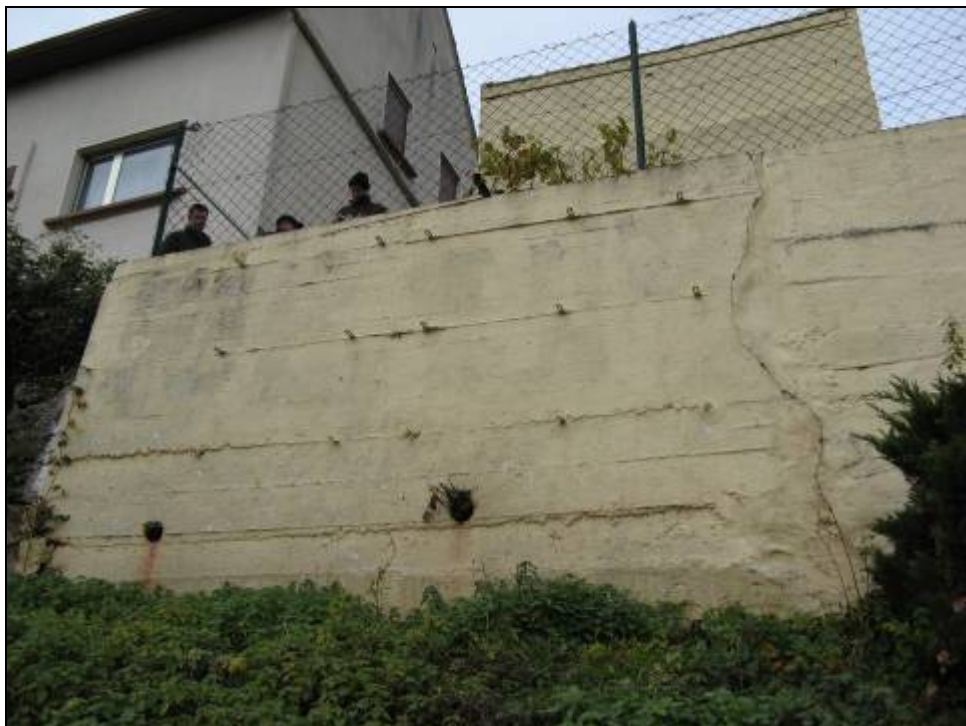
Photo 62 - Mur de soutènement fissuré et bombé en parcelle 158.
