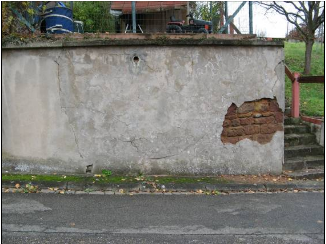
Photo 69 - Mur fissuré de la parcelle 106.
