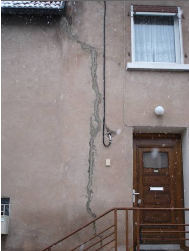
Photo 16 - Fissures observées en mars 2008 sur la parcelle 146.
