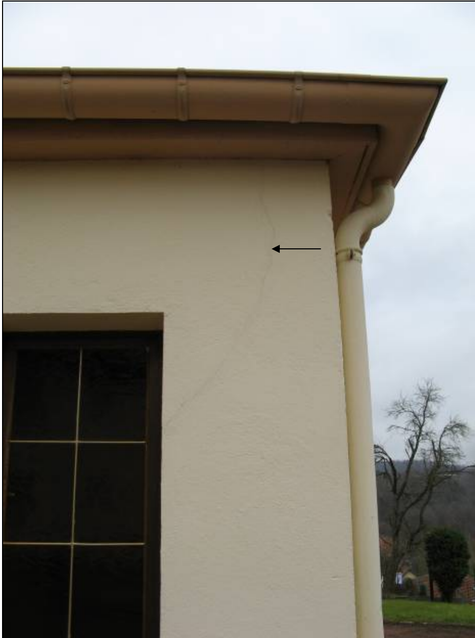
Photo 26 - Fissure observée sur la chapelle.
