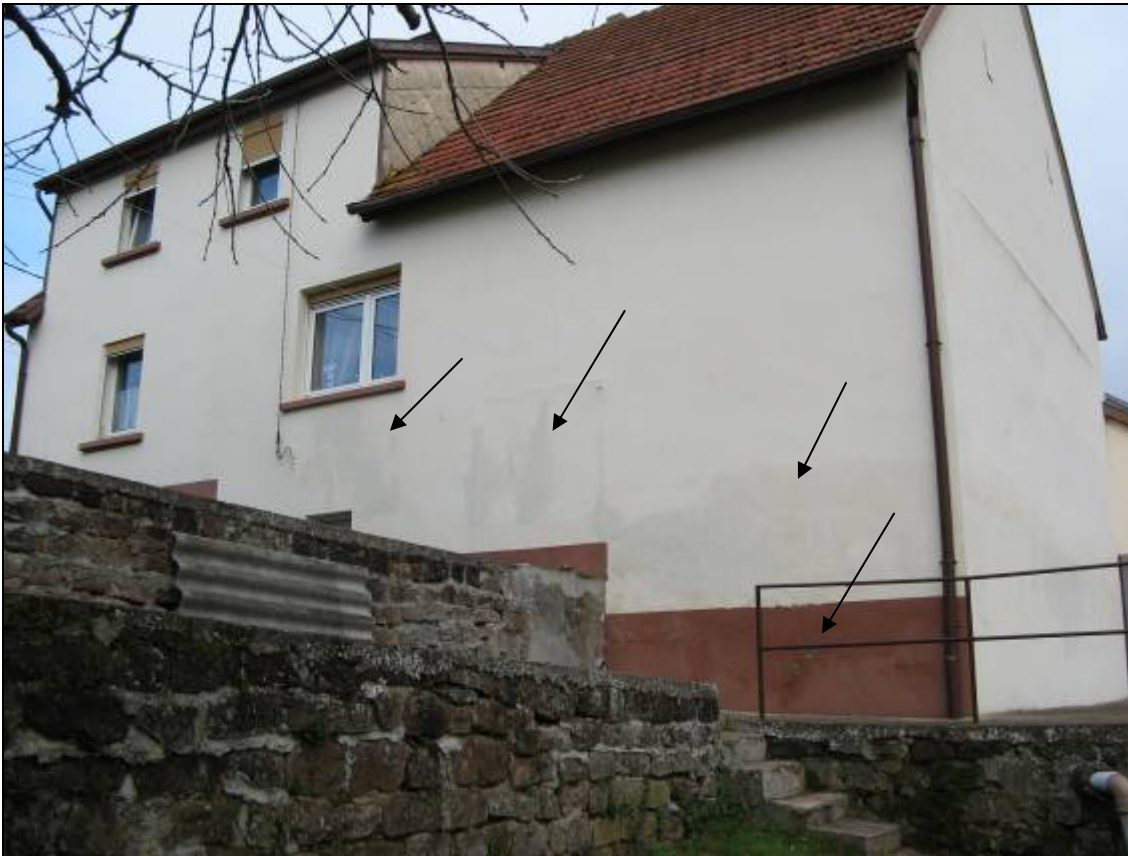
Photo 51- Positionnement des fissures rebouchées observées sur la maison de la parcelle 140.
