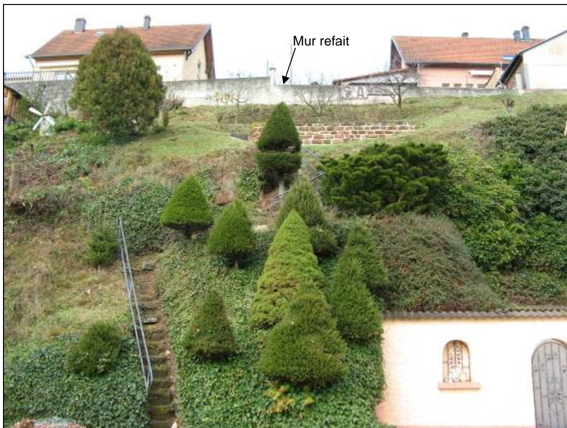
Photo 40 - Vue de la parcelle 212 sur le mur refait en 2001, suite à des désordres, en limite des parcelles 220 de la carte 1 et 159 de la carte 2.
