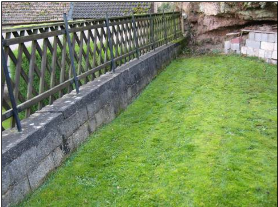
Photo 8 - Affaissement et bombement au niveau de la terrasse intermédiaire de M. Sahling.
