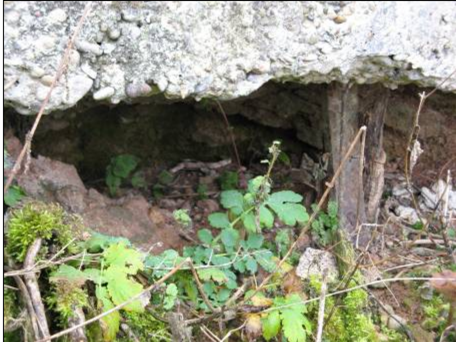
Photo 3 - Etat de la falaise sous le jardin derrière la maison de M. Sahling (forte altération).
