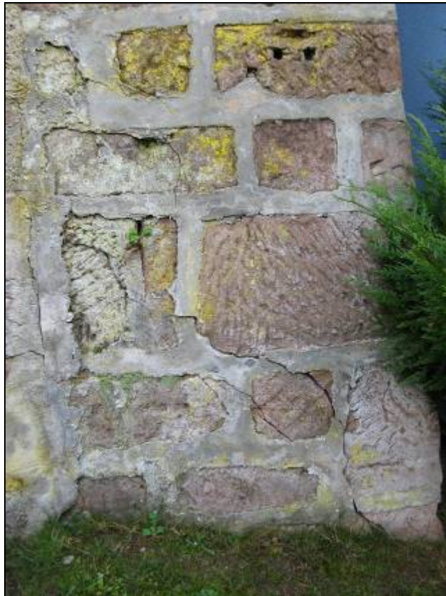
Photo 12 - Fissure du mur de soutènement communal jointif, en contrebas sous la terrasse intermédiaire de M. Sahling (accès à partir de la parcelle 146).
