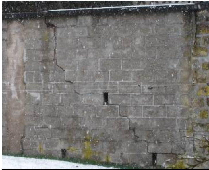
Photo 11 - Fissure du mur (vue en mars 2008).
