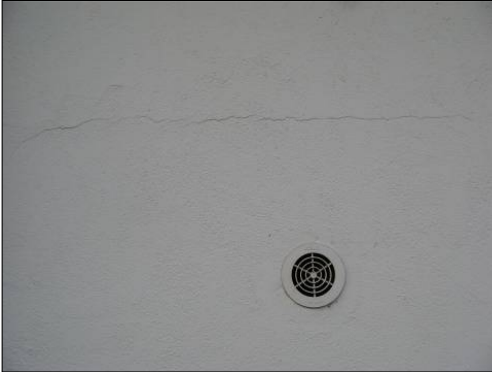
Photo 18 - Fissure horizontale observée sur la maison de la parcelle 143.
