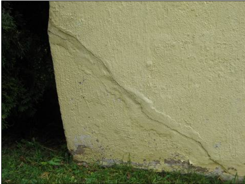
Photo 61 - Fissure du bâtiment (partie haute de la pente), en parcelle 158.
