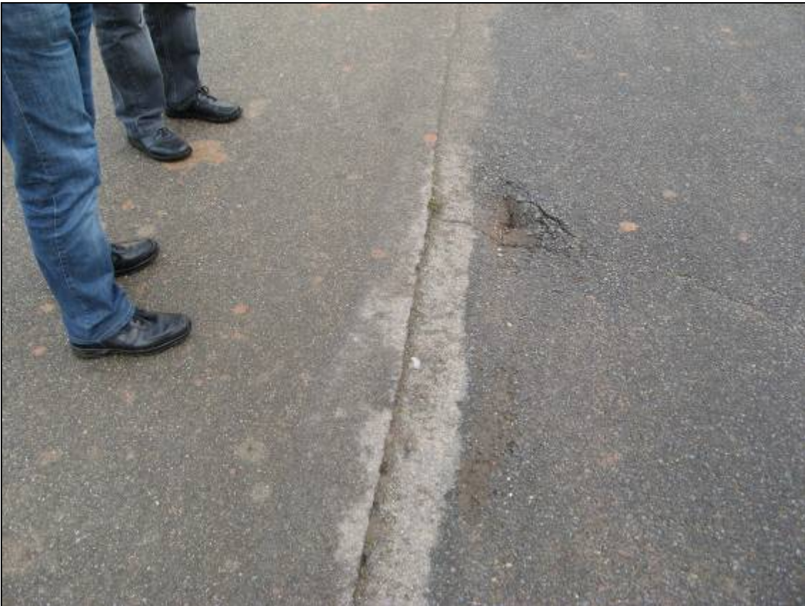
Photo 58 - Trou en formation dans la chaussée près des parcelles 157 et 158.
