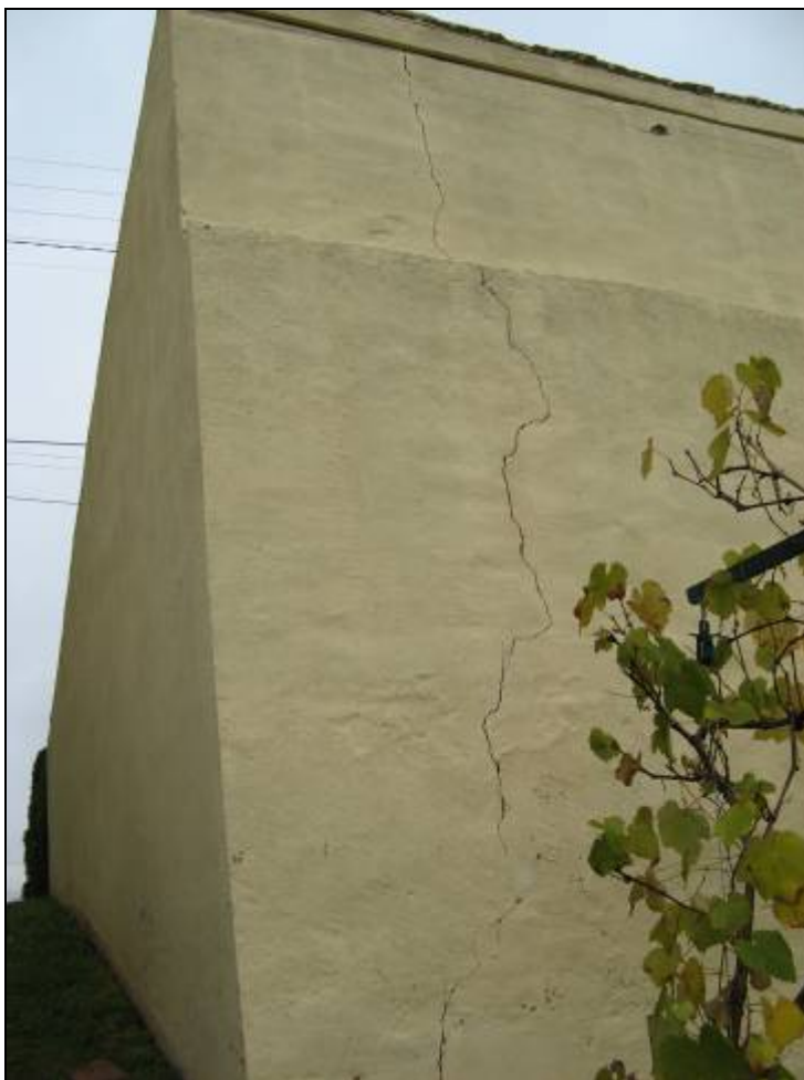
Photo 60 - Bâtiment annexe fissuré en face est, avec décollement en bas de 5 mm, en parcelle 158.
