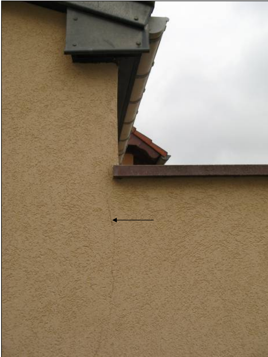
Photo 66 - Fissure sur la maison de la parcelle 159.
