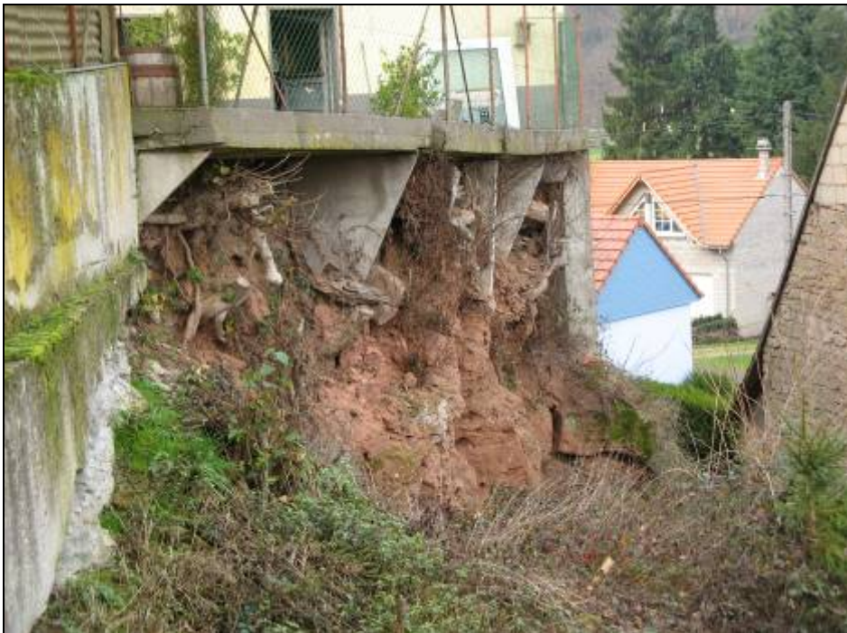
Photo 2 - Etat de la falaise sous la terrasse derrière la maison de M. Sahling (forte altération, bloc décollé).
