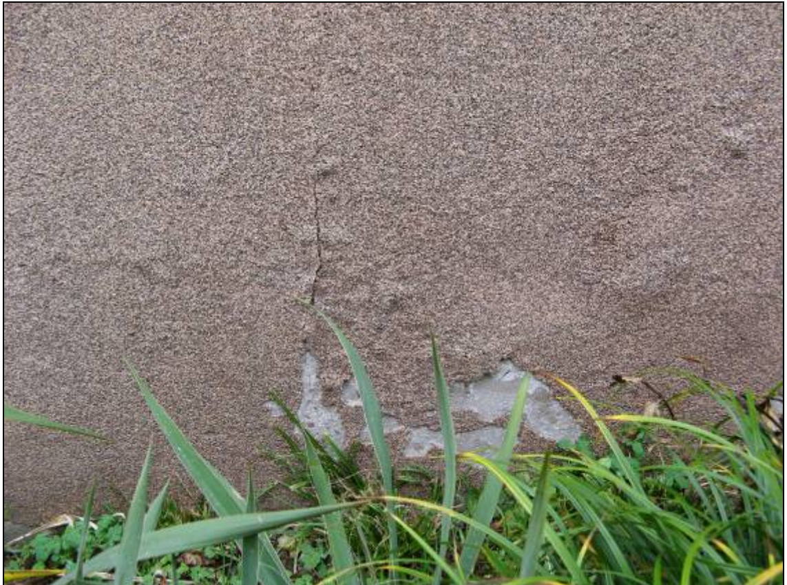
Photo 52 - Fissures observées du côté nord de la maison de la parcelle 157.
