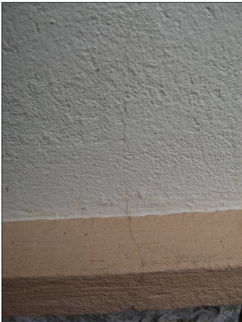
Photo 30 - Fissure observée sur la chapelle.
