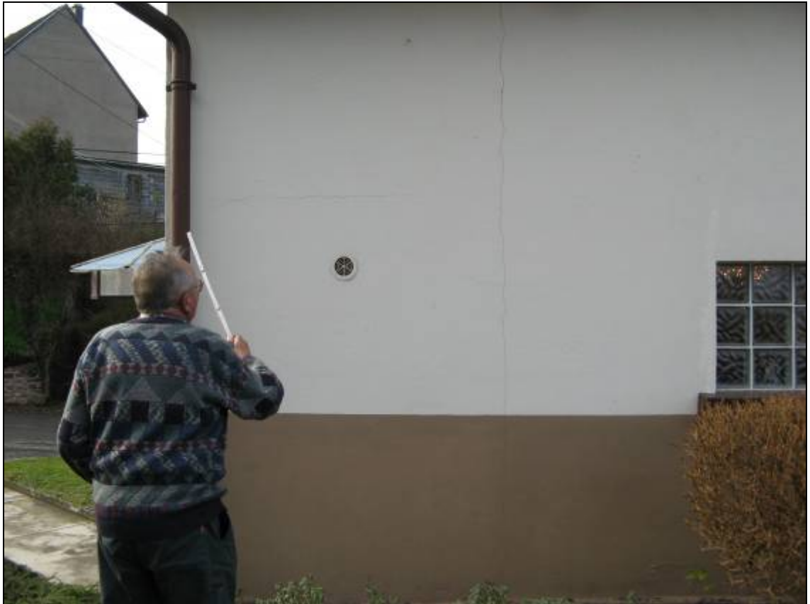
Photo 17 - Fissures observées sur la maison de la parcelle 143.
