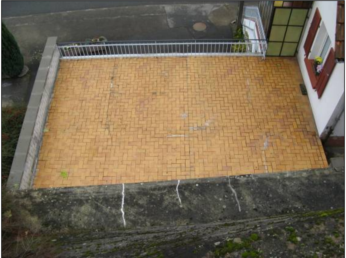
Photo 35 - Fissures de la terrasse de la maison de la parcelle 95, en contrebas de la mairie.
