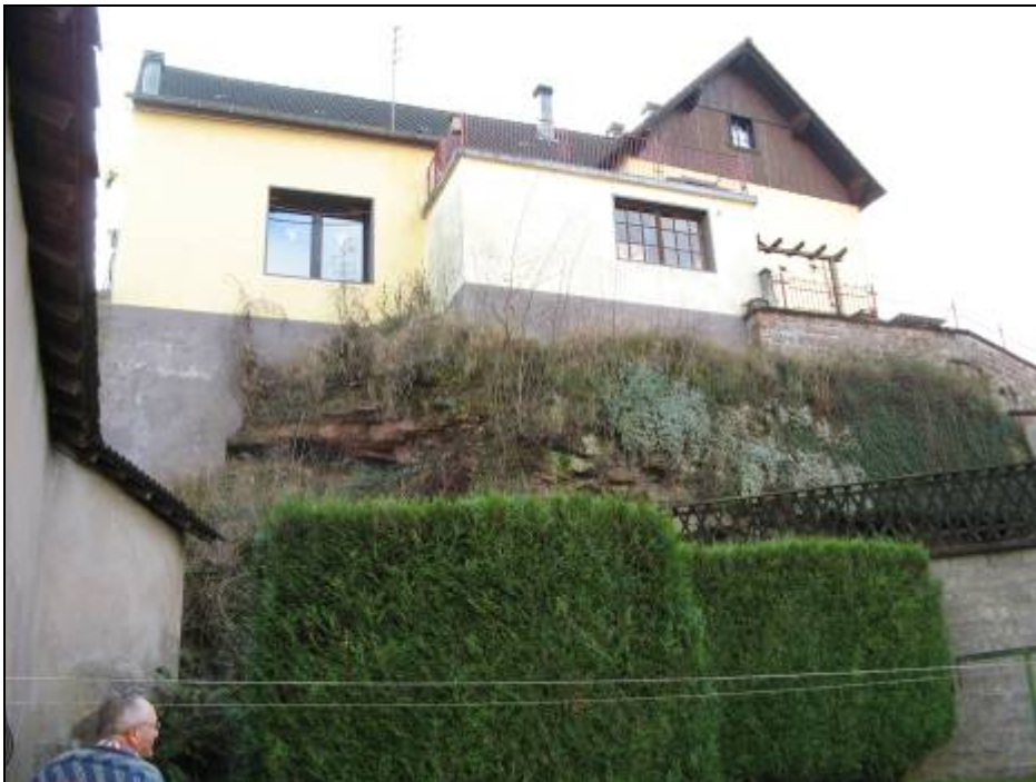
Photo 14 - Vue d'ensemble de la falaise et du bâtiment de la maison de M. Sahling (accès à partir de la parcelle 146).
