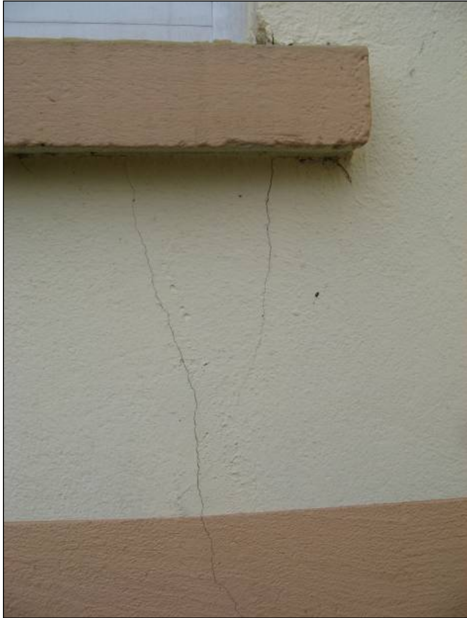
Photo 29 - Fissures observées sur la chapelle.
