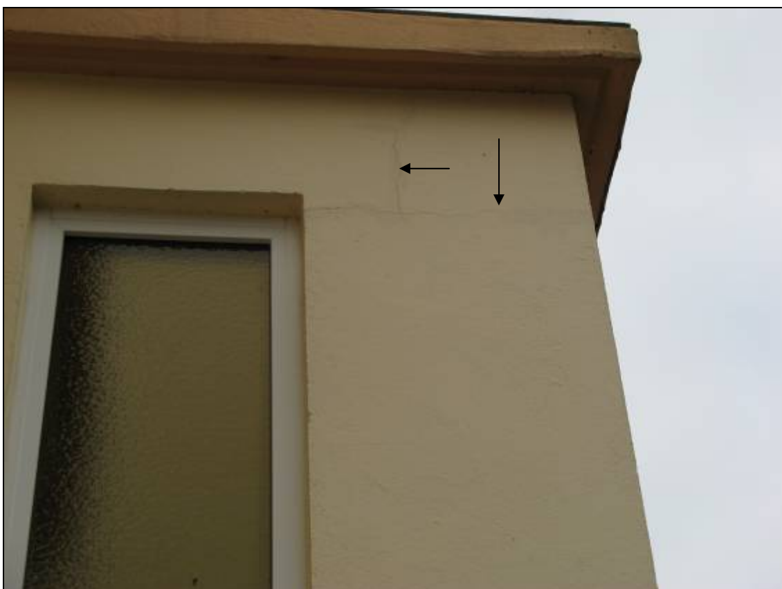
Photo 27 - Fissures observées sur la chapelle.
