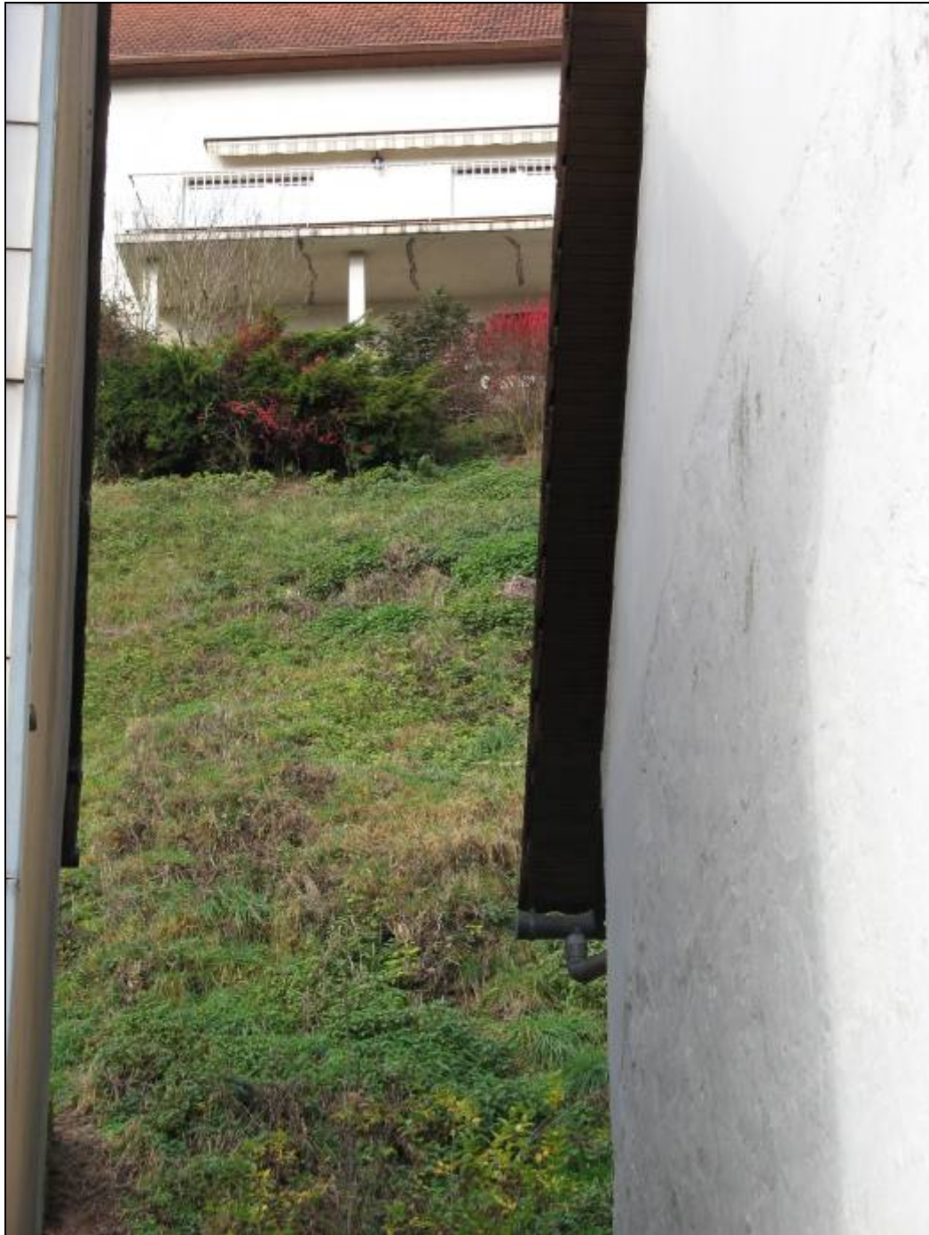
Photo 42 - Depuis la parcelle 163, vue sur la parcelle 157 où il y a le balcon fissuré.
