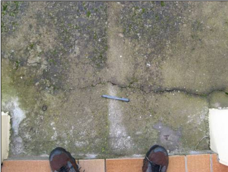
Photo 63 - Trottoir fissuré devant l'entrée de la maison de la parcelle 158.
