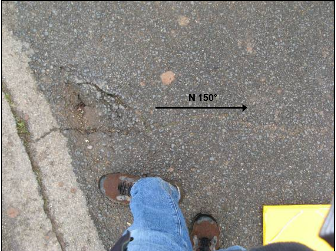
Photo 59 - Trou en formation d'orientation N 150° dans la chaussée près des parcelles 157 et 158.
