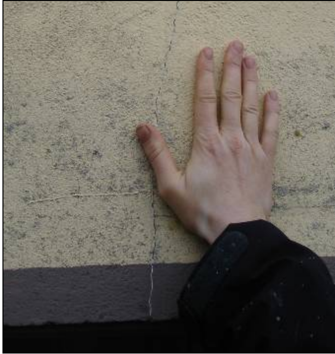
Photo 5 - Fissure sur le bâtiment du côté est jouxtant la terrasse, derrière la maison de M. Sahling (déjà vue en mars 2008).
