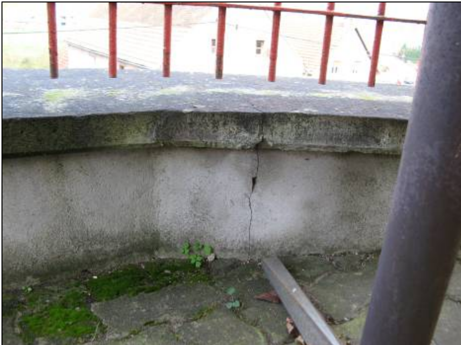
Photo 6 - Fissure du mur de la terrasse devant la maison de M. Sahling.
