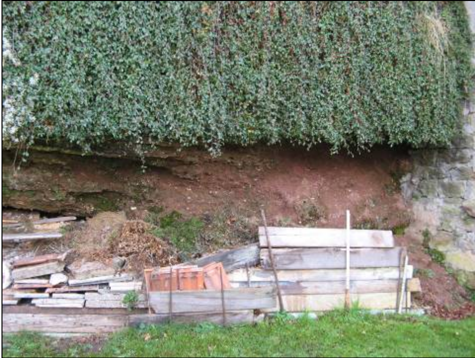
Photo 9 - Falaise gréseuse effritée au niveau de la terrasse intermédiaire de M. Sahling.
