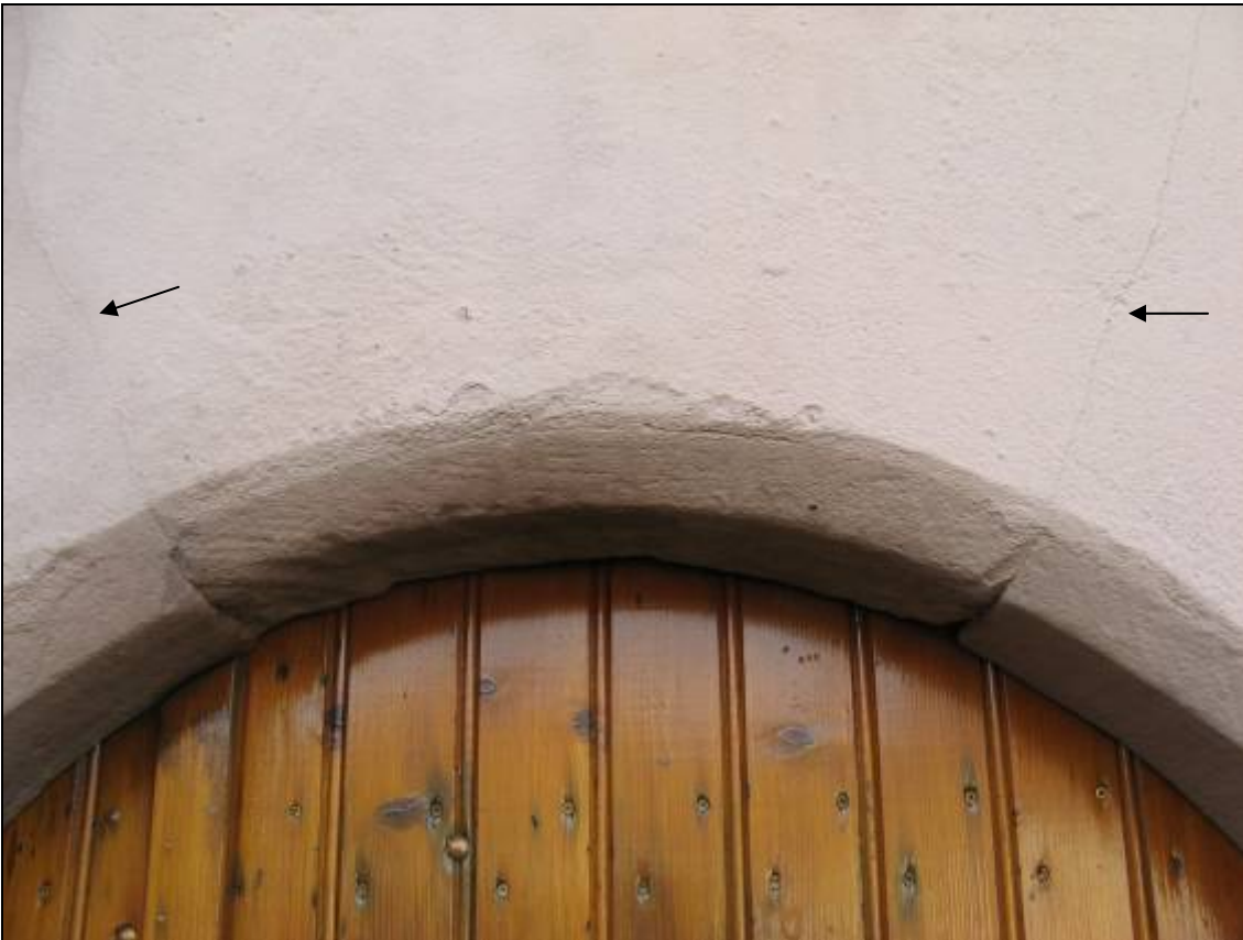
Photo 22 - Fissures observées sur la maison de la parcelle 143.
