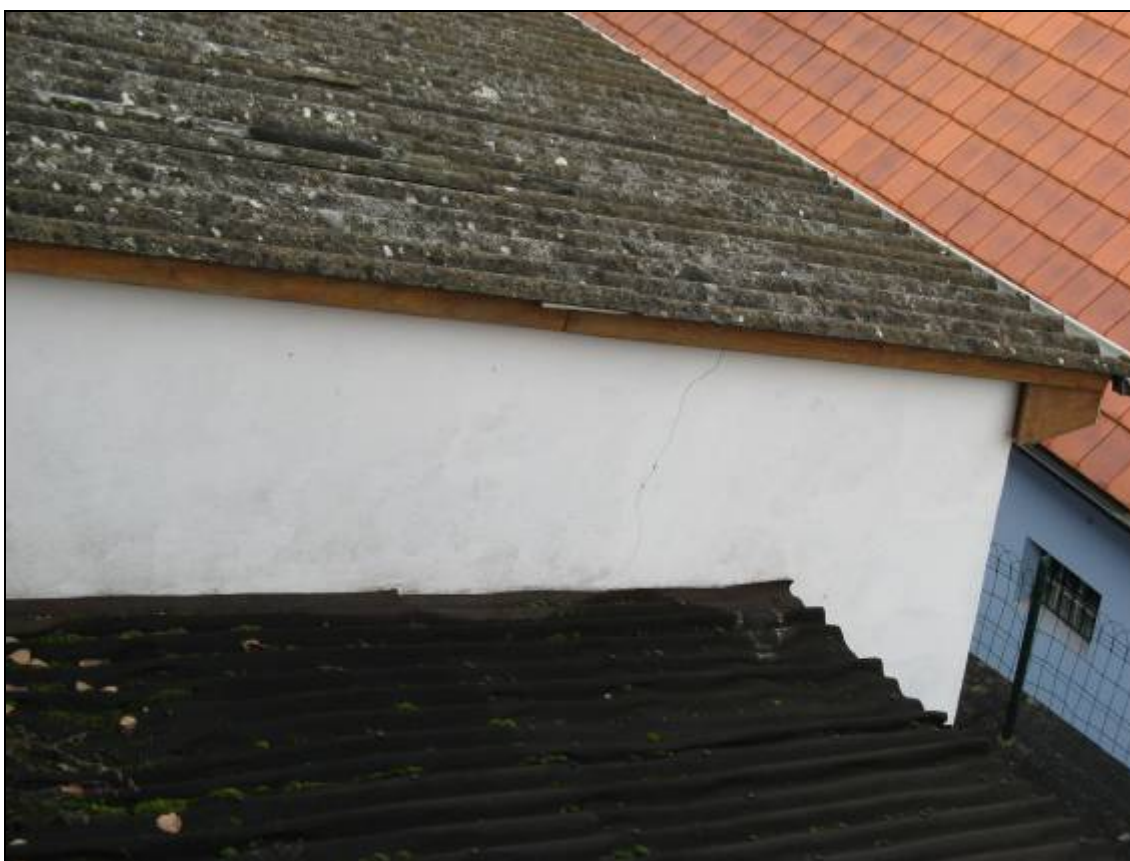
Photo 23 - Fissure observée sur la maison de la parcelle 143.
