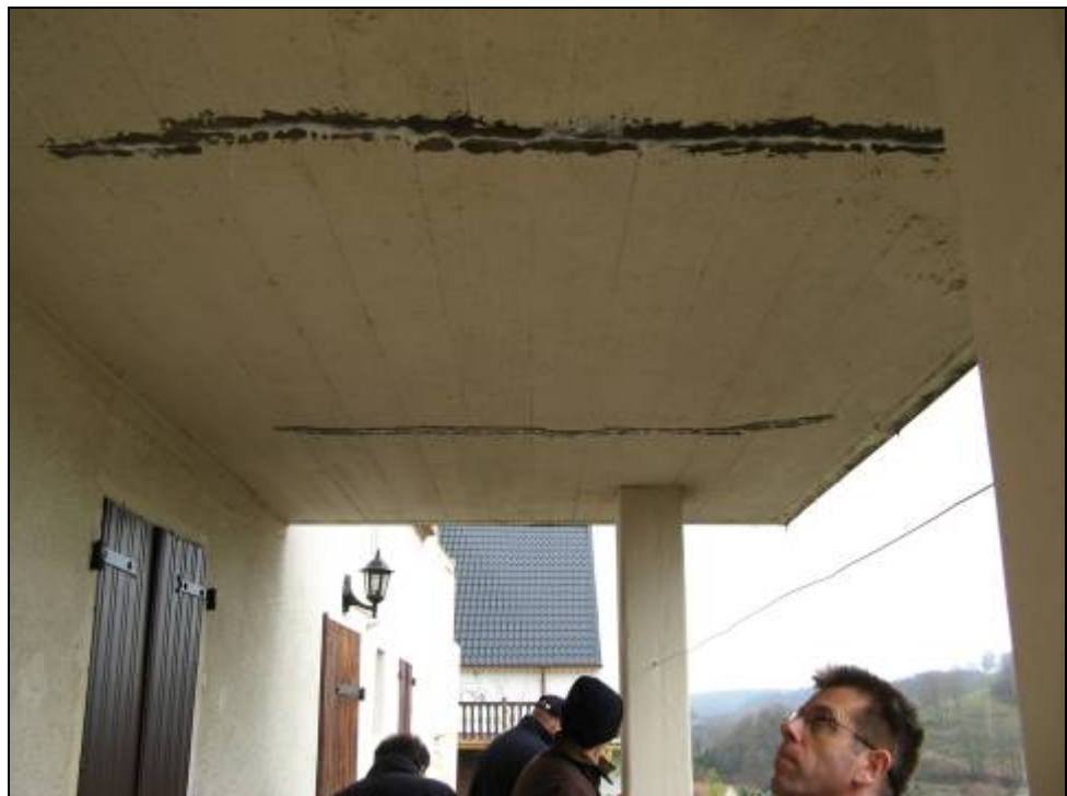
Photo 55 - Fissures sous le balcon au-dessus de la terrasse de la parcelle 157.
