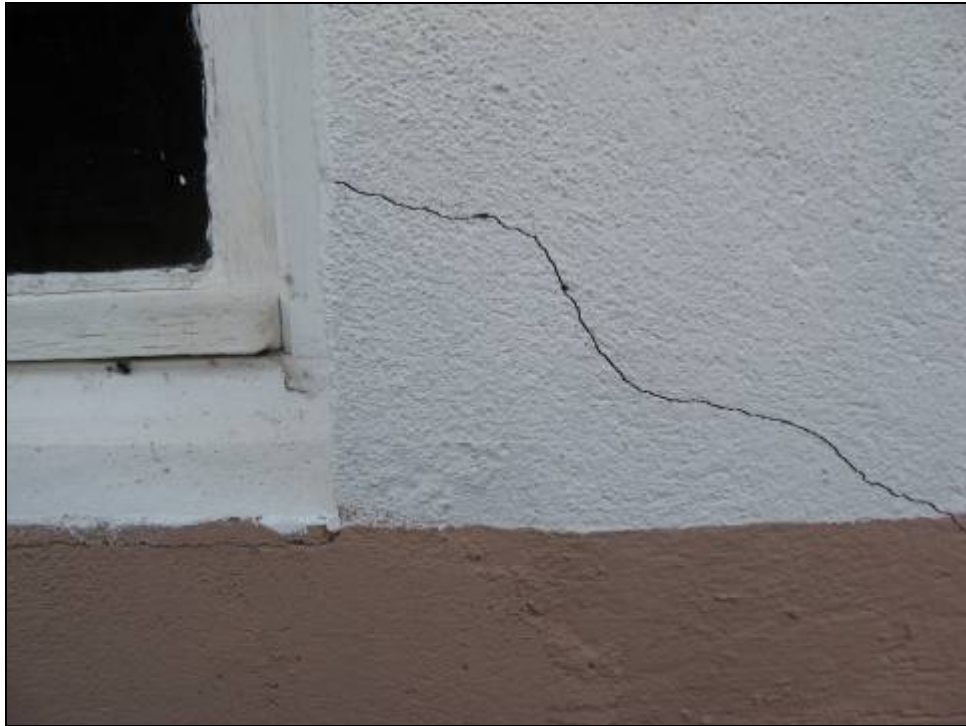
Photo 20 - Fissure observée sur la maison de la parcelle 143.
