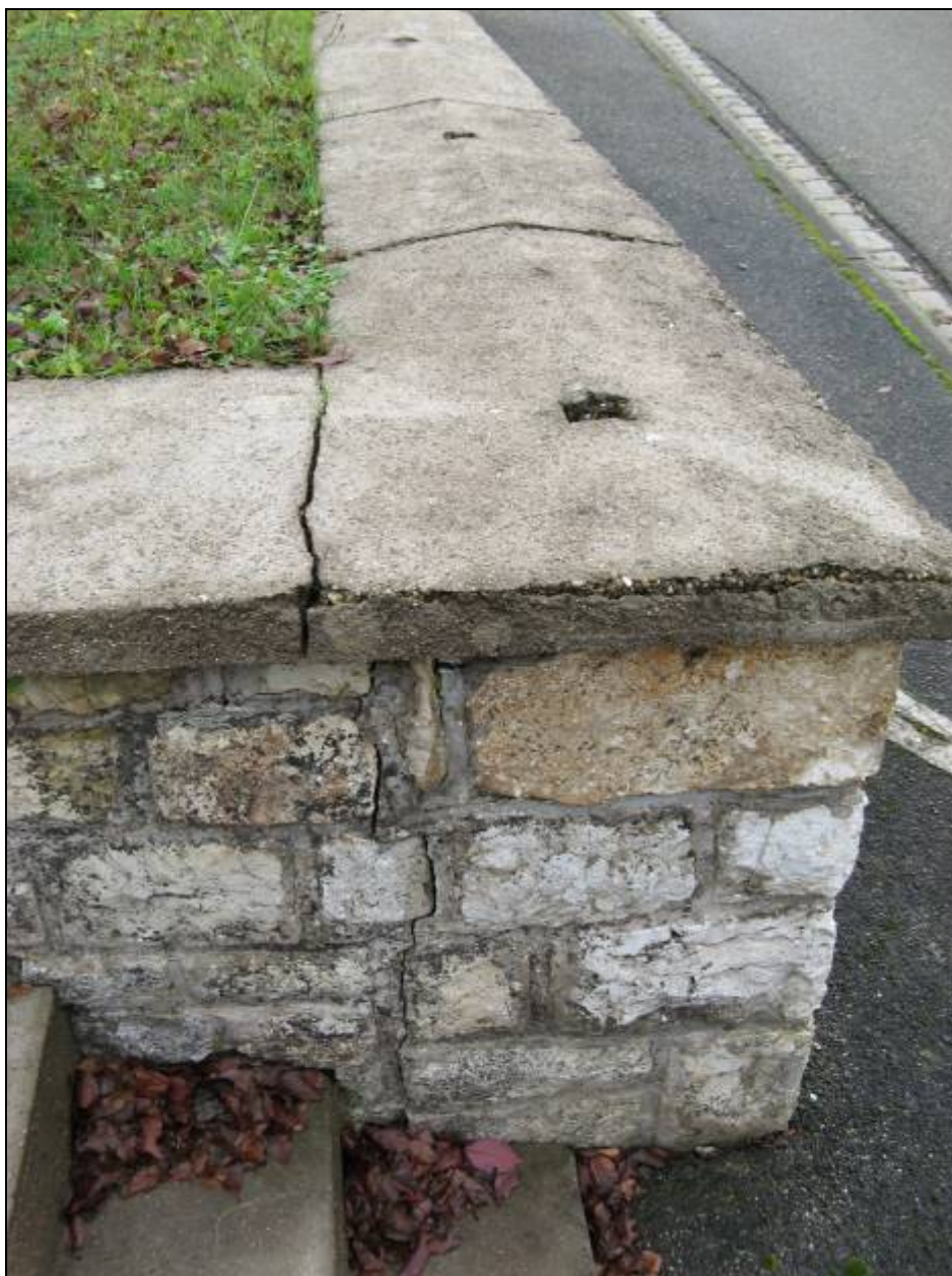
Photo 31 - Fissure du muret devant la chapelle du côté de la rue de la Forêt.
