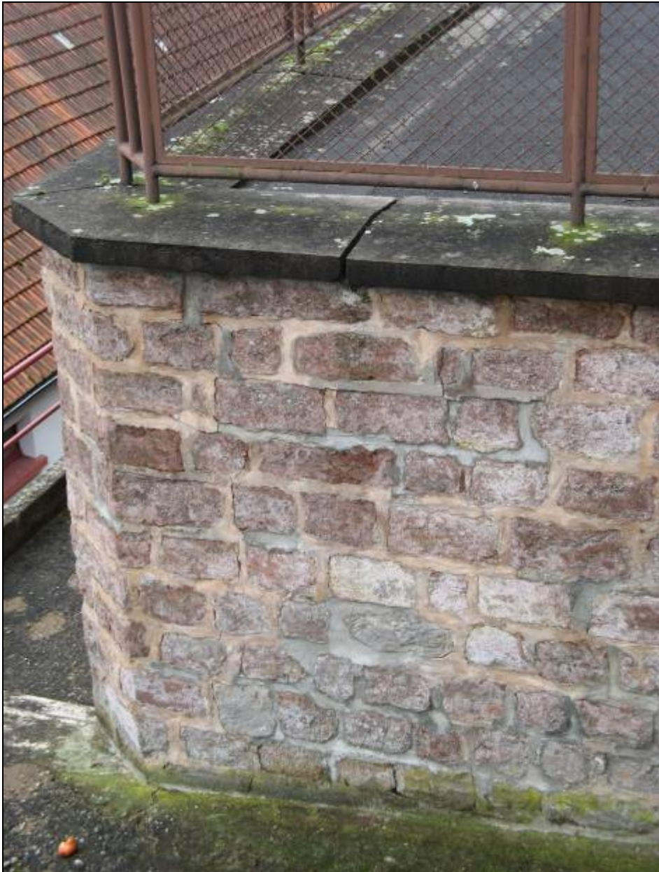
Photo 34 - Fissure du mur de soutien de la terrasse de la mairie.
