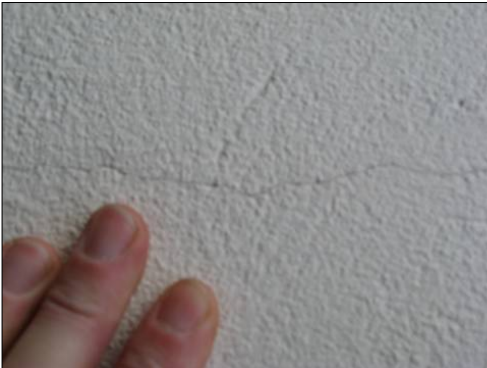
Photo 19 - Fissures observées sur la maison de la parcelle 143.
