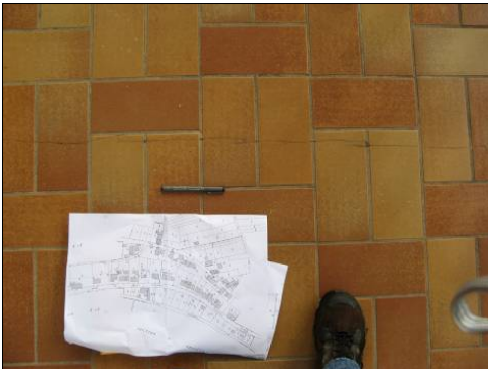
Photo 64 - Fissure du carrelage devant l'entrée de la maison de la parcelle 158.
