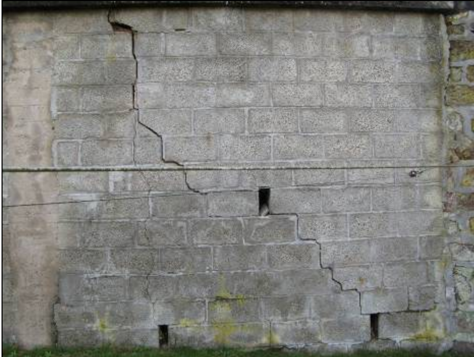
Photo 10 - Fissure du mur bombé en contrebas sous la terrasse intermédiaire de M. Sahling (accès à partir de la parcelle 146).
