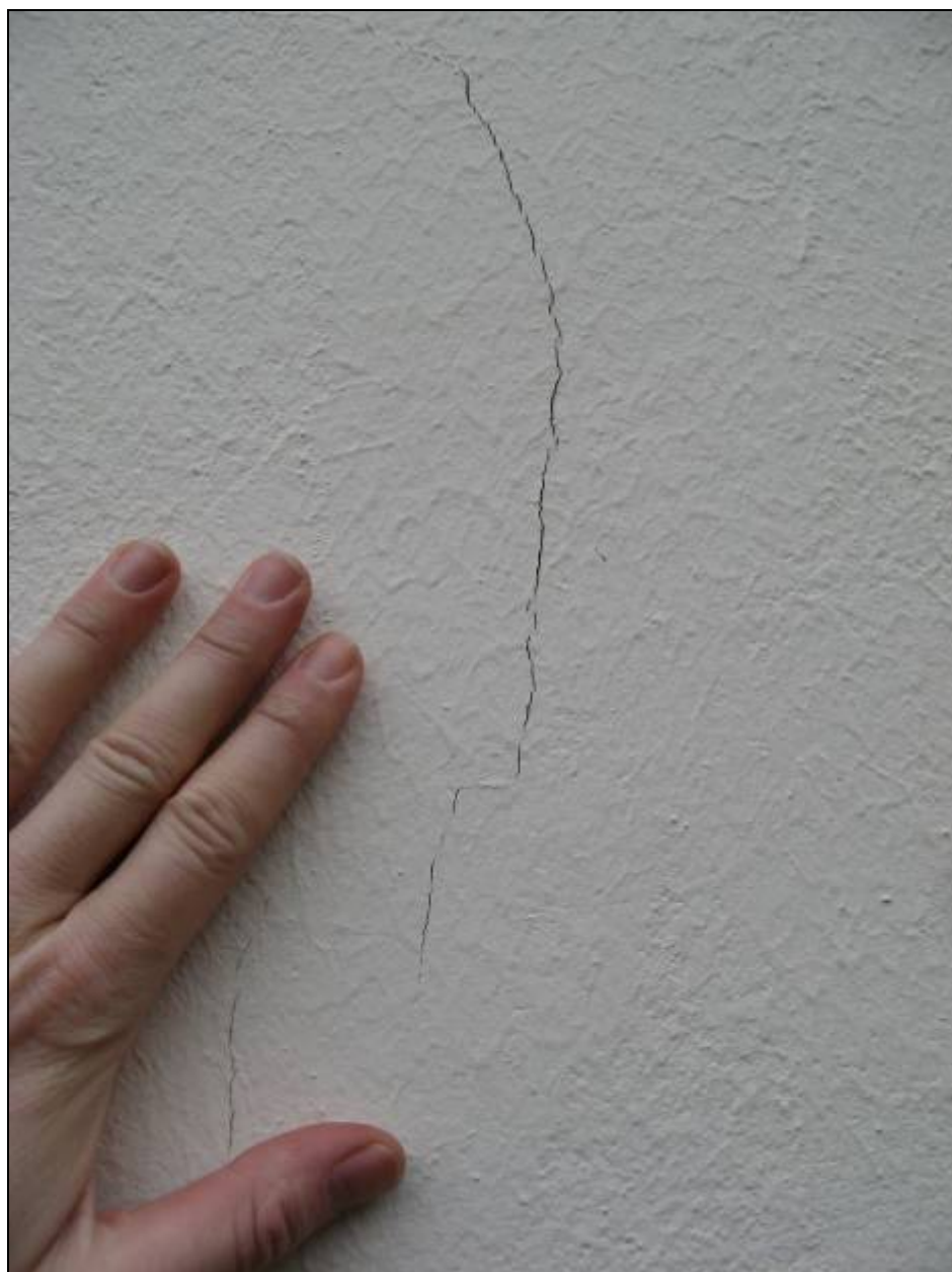
Photo 25 - Fissure observée sur la maison de la parcelle 141.
