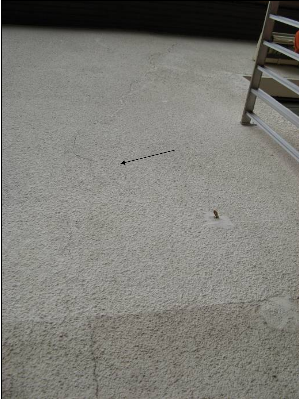
Photo 56 - Fissure sur le mur du côté est de la maison (près du balcon) de la parcelle 157.
