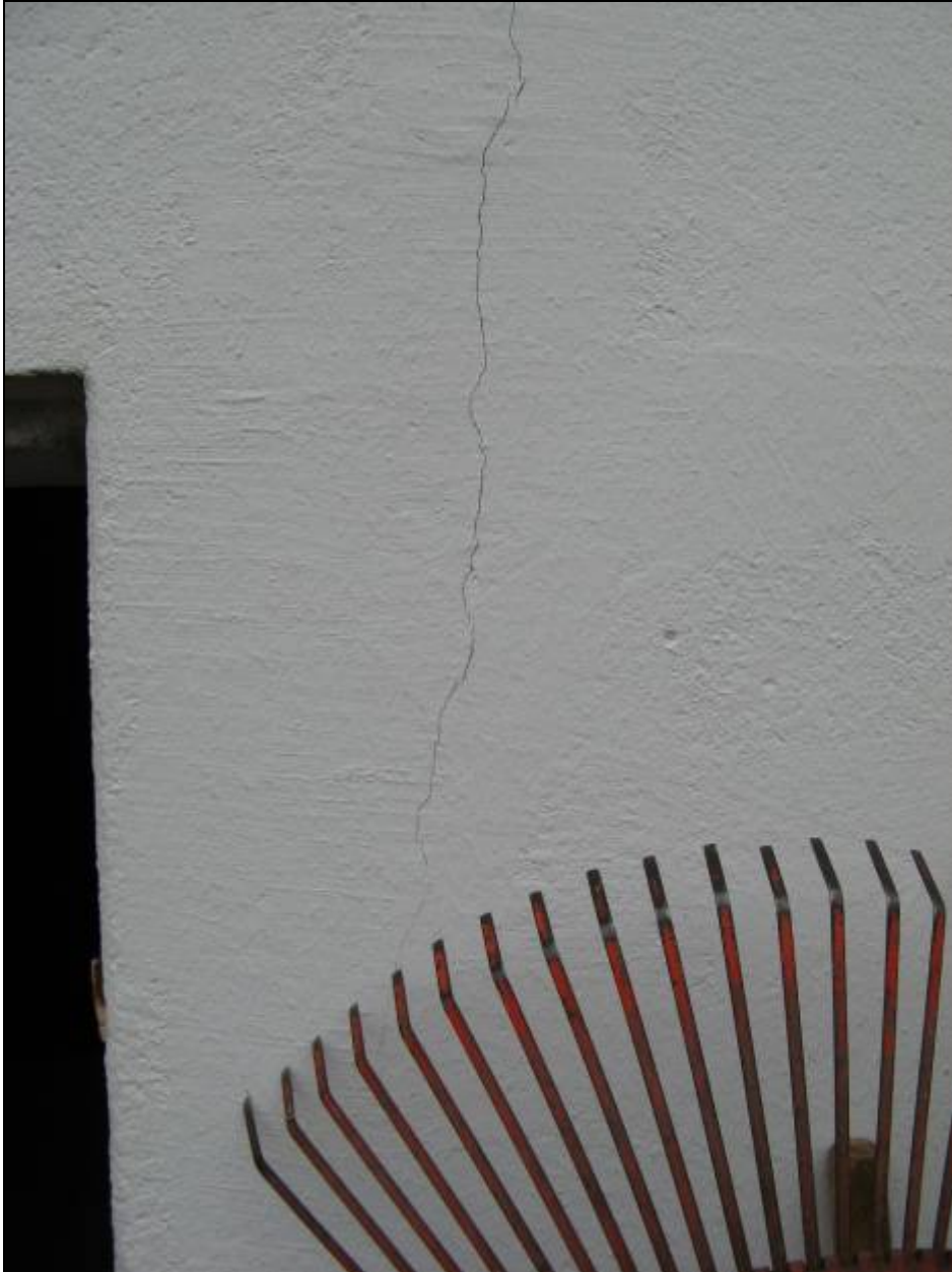
Photo 24 - Fissure observée sur la maison de la parcelle 141.
