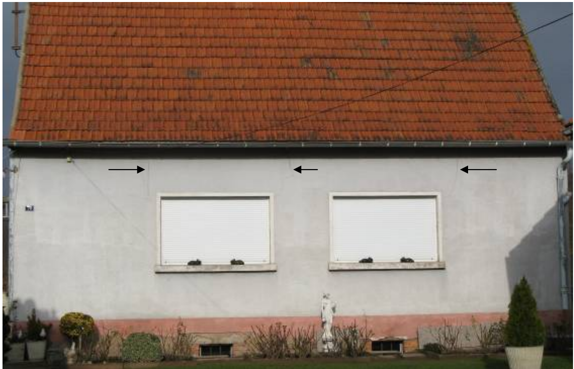
Photo 67 - Fissures sur la maison de la parcelle 145.
