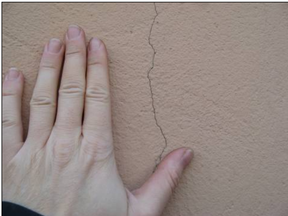
Photo 21 - Fissure observée sur la maison de la parcelle 143.
