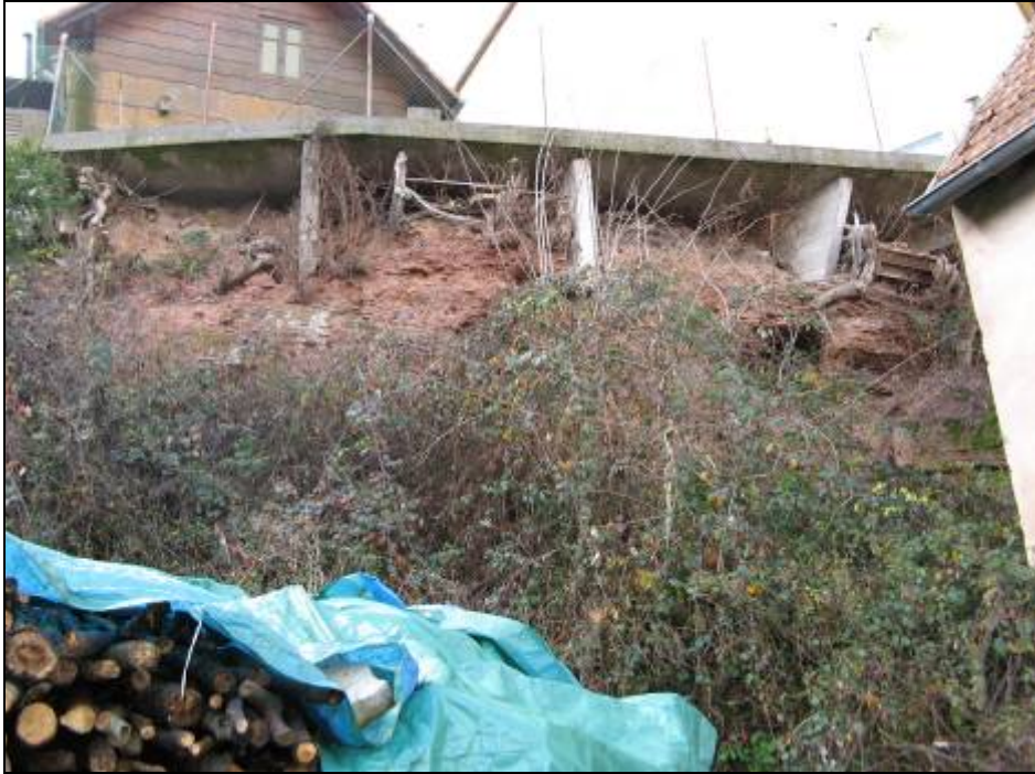
Photo 1 - Falaise sous la terrasse derrière la maison de M. Sahling (vue à partir de la parcelle 146).
