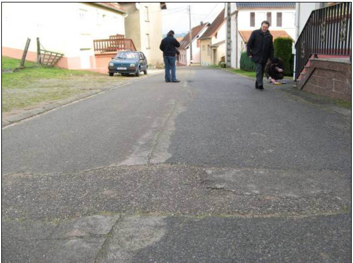
Photo 57 - Affaissement de la chaussée près des parcelles 157 et 158.
