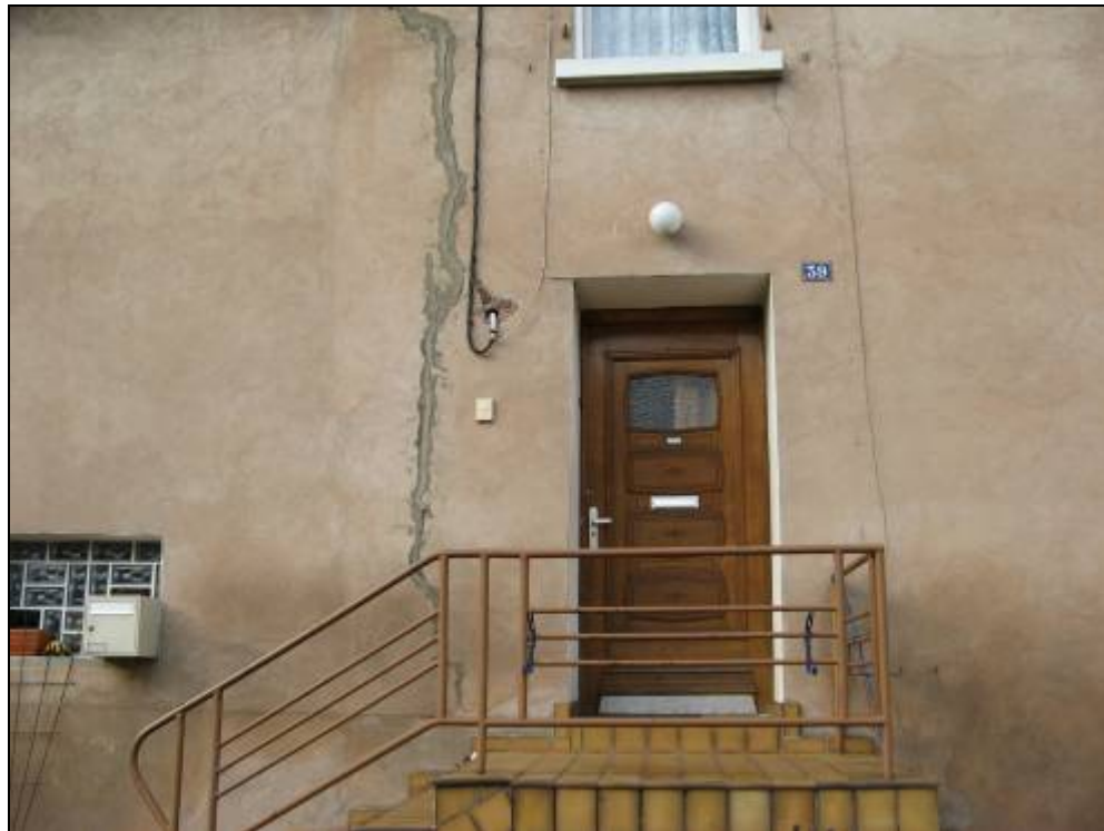
Photo 15 - Fissures sur la maison de la parcelle 146.
