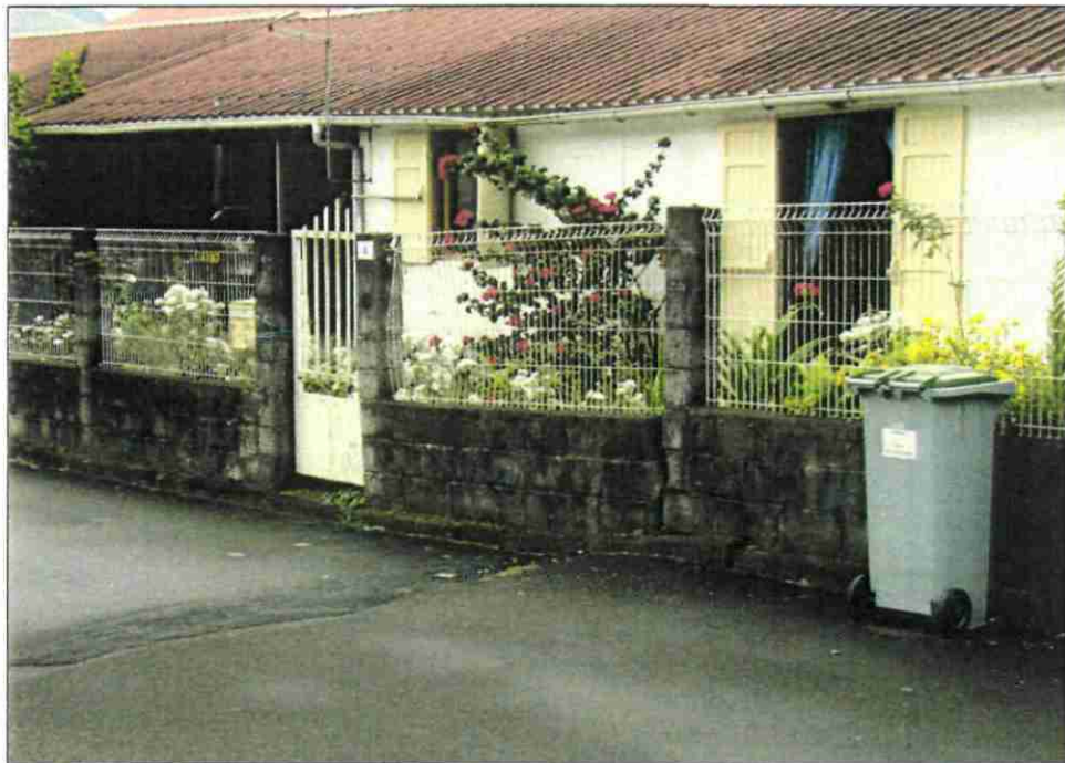
Figure 18 : Fissure active dans le lotissement des Bambous
