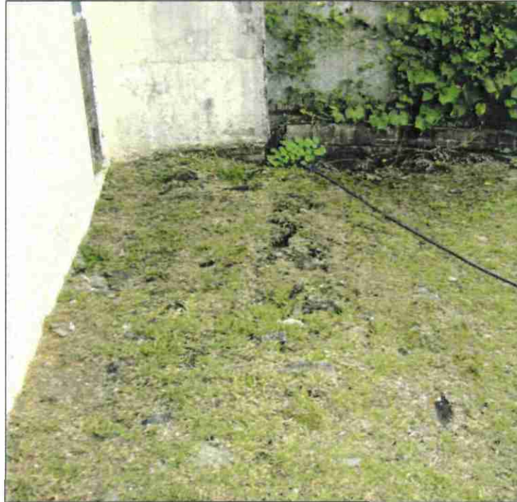
Figure 17 : Fissure active dans l'emprise de l'ancienne école de Mare à Poule d'Eau
