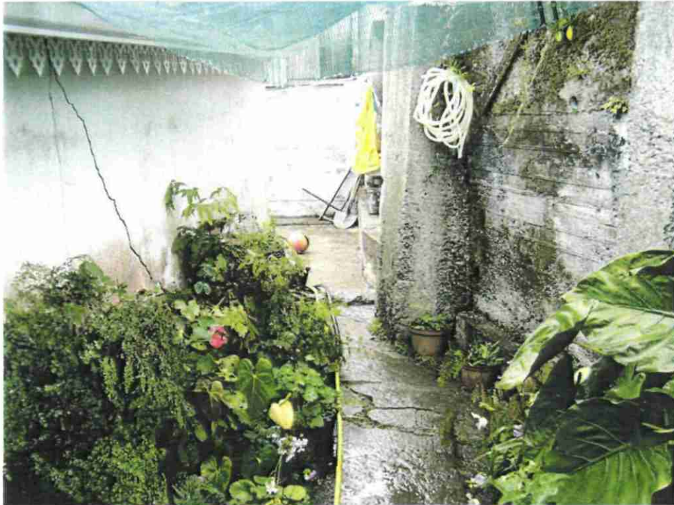
Figure 31 : Point 5 - Continuité vers l'Est de la faille visible sur la figure 3 (construction en surplomb de la route d'Hell-Bourg RD 48)
