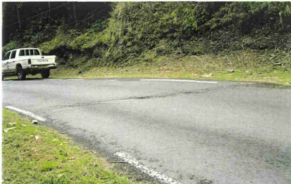
Figure 32 : Point 6 – Fissuration de la RD 48 descendant vers le Bras Fontaine (direction N160°)
