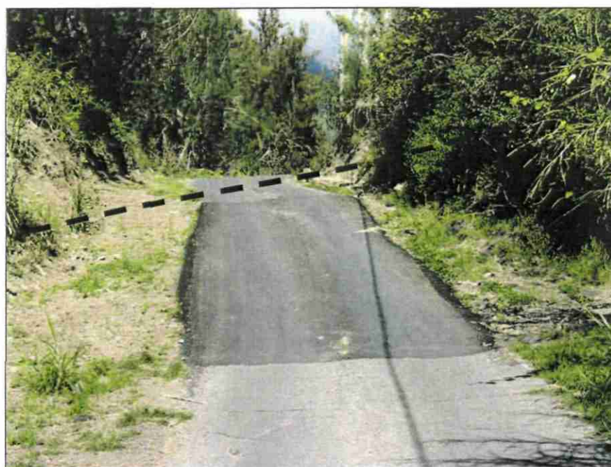
Figure 20 : Faille active avec rejeux ? plurimétriques
