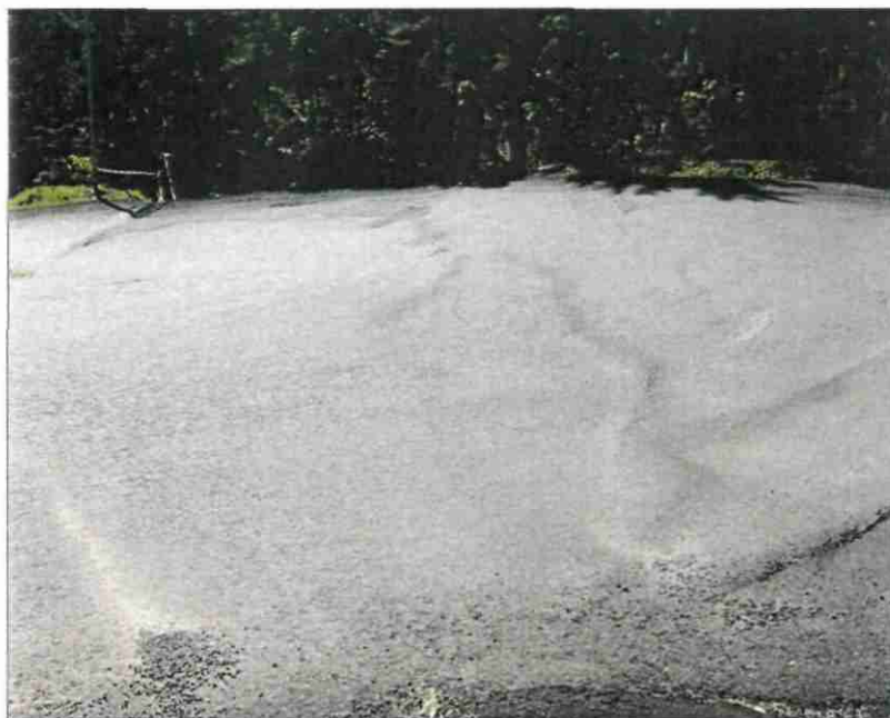
Figure 15 : Réseau de fissures décrochantes affectant la RD48 – Secteur dit des « tournants bambous »
