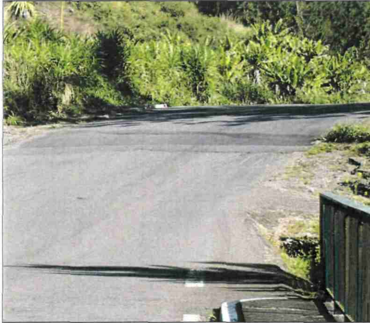
Figure 14 : Bombement de la RD48 au front du glissement (cliché pris au droit de l'ouvrage de franchissement de la ravine drainant la mare à Poule d'Eau – point coté IGN 533 m)
