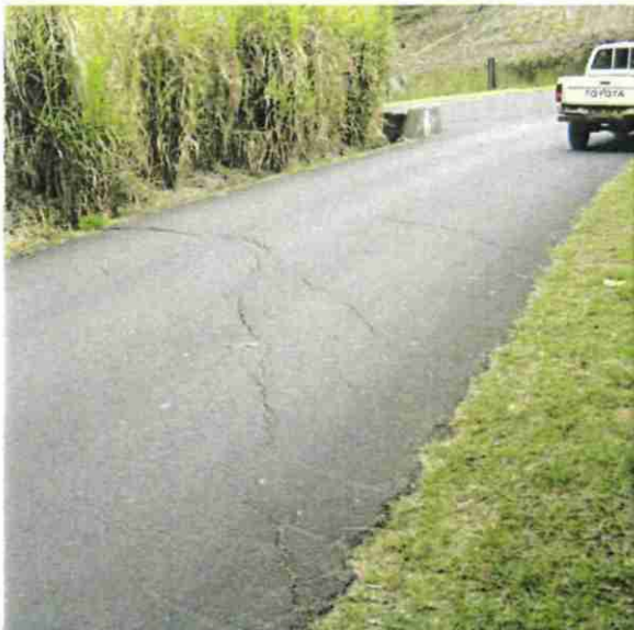
Figure 27 : Point 1 – Fissuration de la chaussée au début du Chemin Manouilh (après Gamède).
