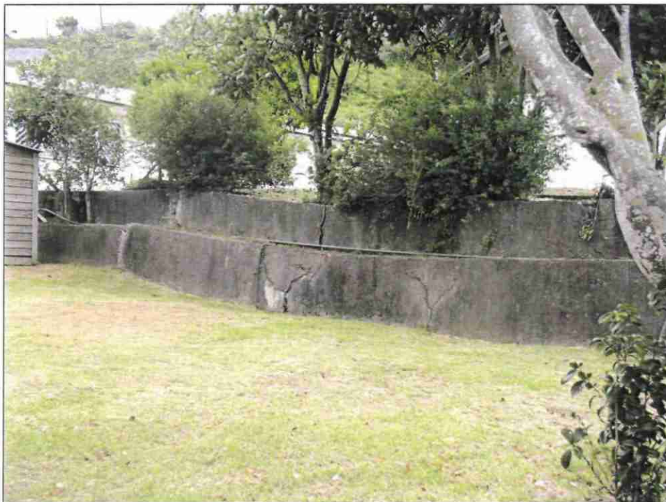
Figure 24 : Désordres aux abords de la mairie annexe de Grand Ilet
