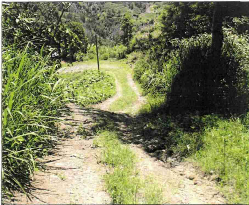
Figure 18 : Déformation apparue sur le Chemin des Bringelliers au cours des 12 derniers mois
