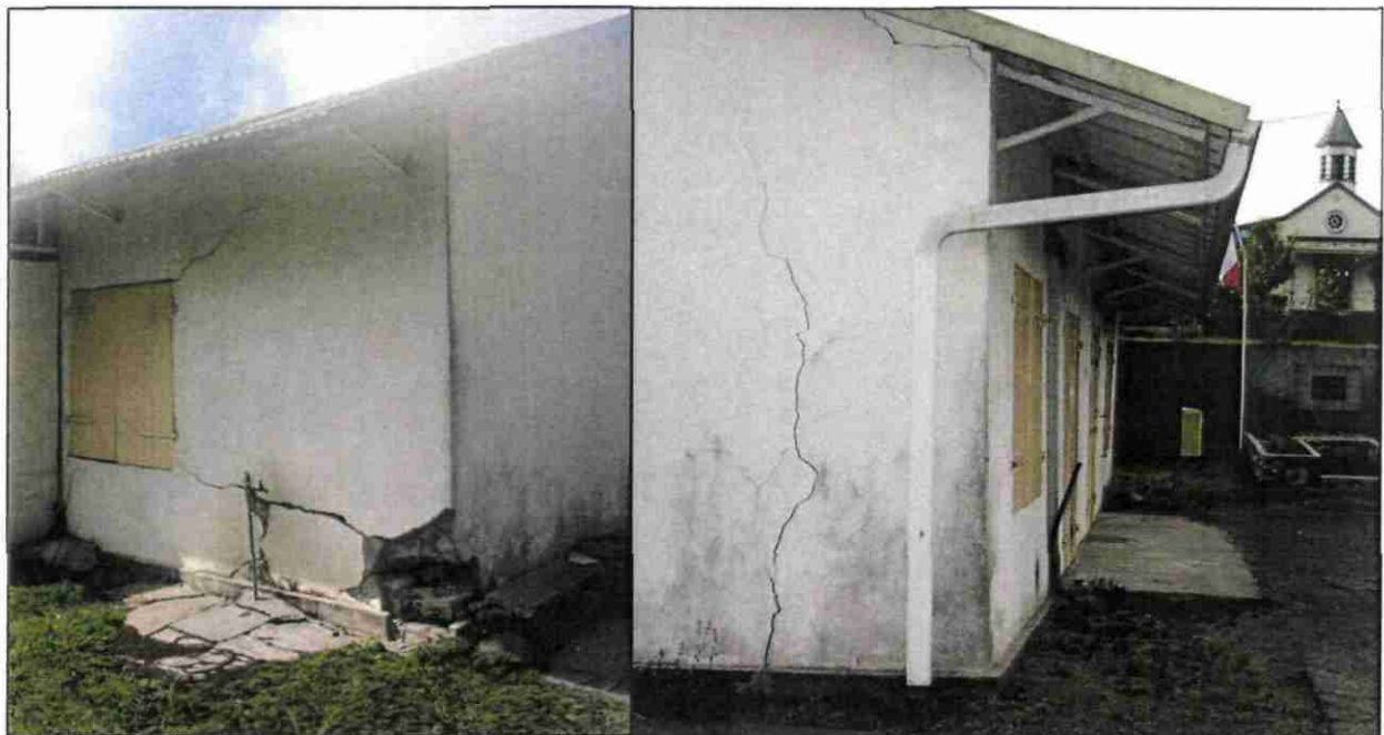
Figure 22 : Désordres au bâtiment abritant La Poste.
