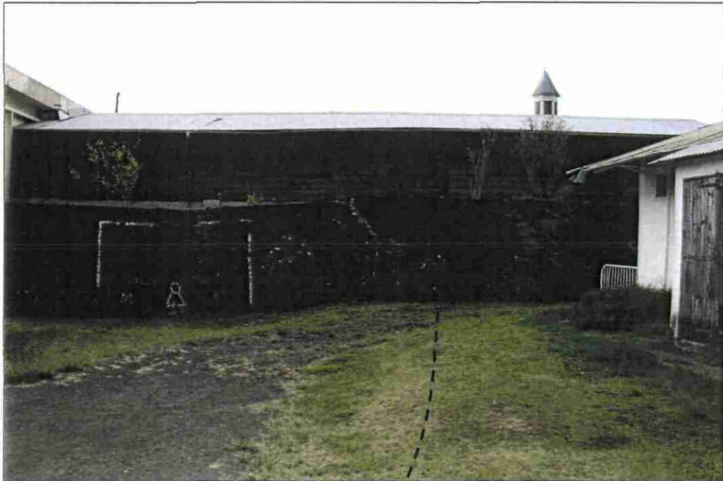
Figure 21 : Désordres aux abords du bâtiment paroissial (à droite au premier plan, bâtiment abritant La Poste)
