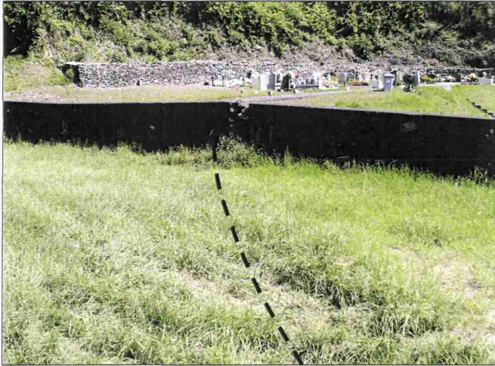
Figure 32 : Désordres sur le mur d'enceinte du cimetière, dans sa partie sud-ouest
