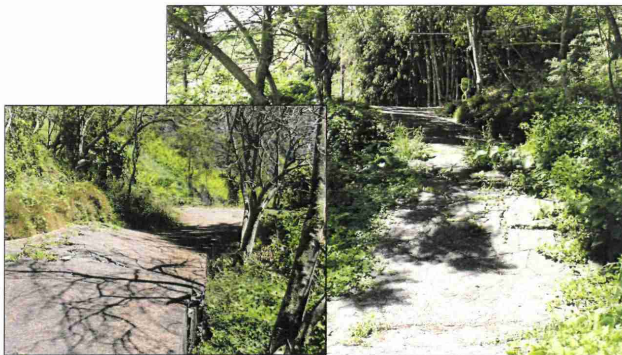
Figure 25 : Désordres affectant l'ancien chemin d'accès au cimetière (rejet métrique)
