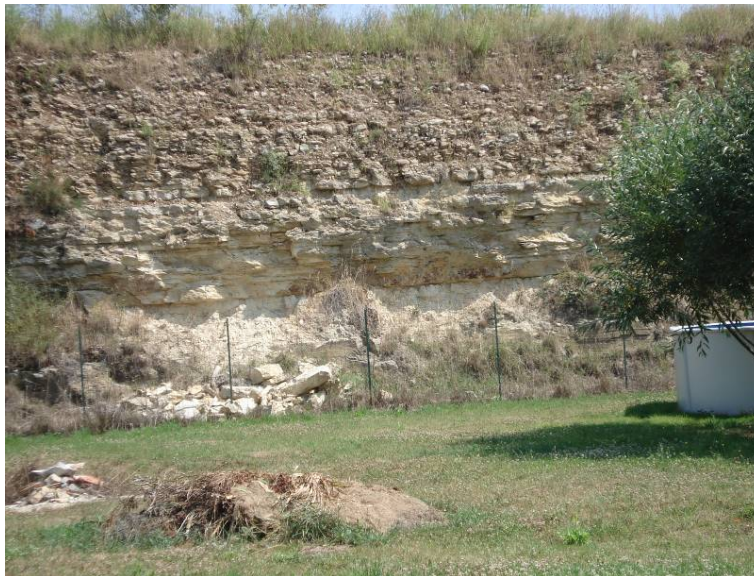
Illustration 22 - Chute de blocs à Chailé-les-Marais
