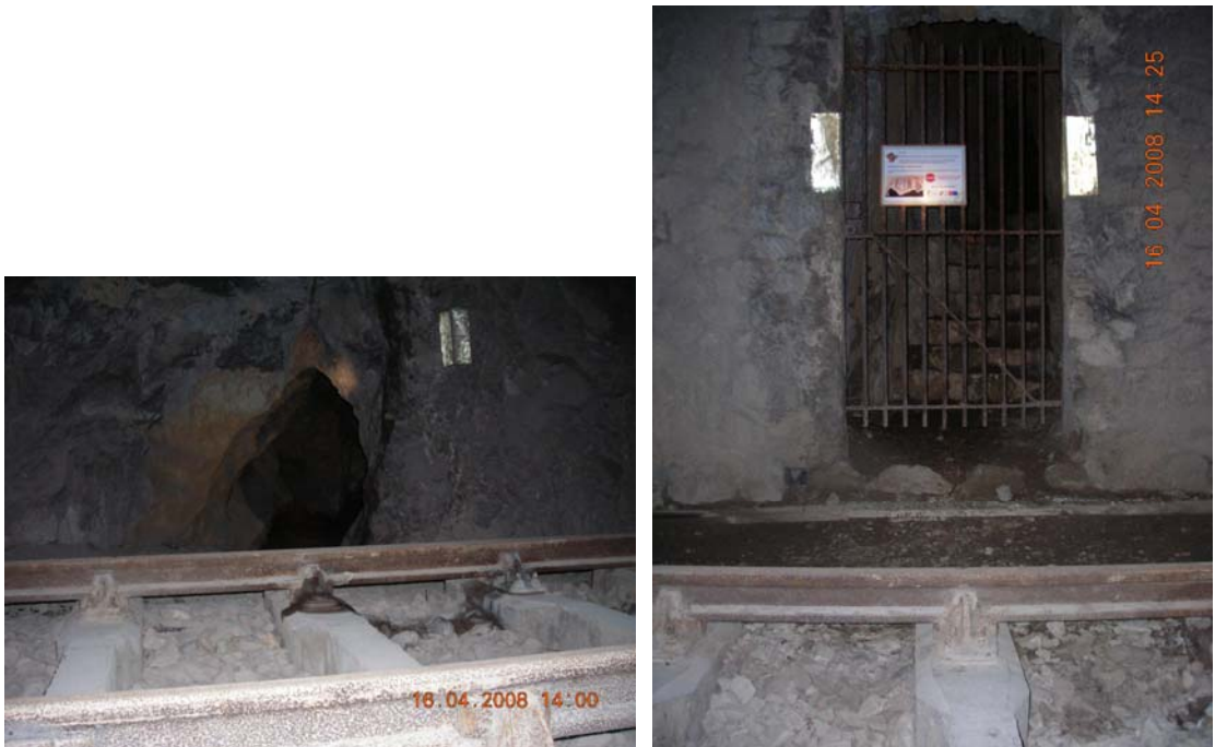
Illustration 14 –Cavité naturelle à l'intérieur d'un tunnel ferroviaire (commune de Camous)
