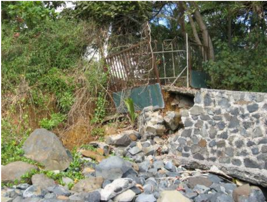
Photo 3 – Rampe d'accès à la mer détruite par l'érosion marine
