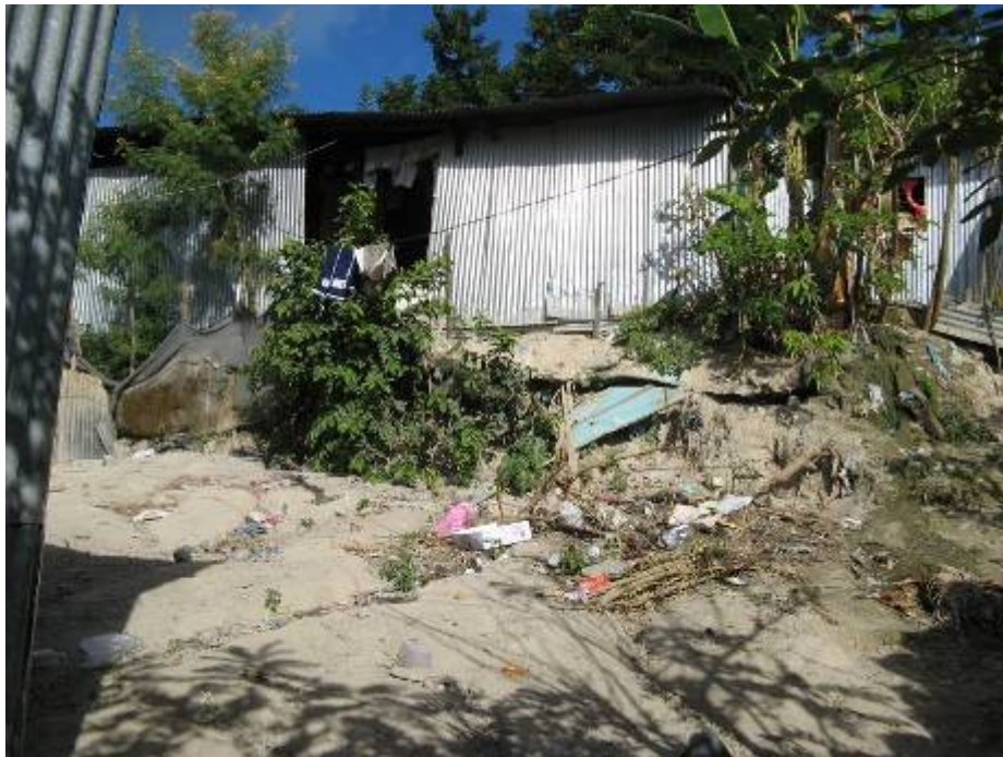
Talus 2 – Sol dénudé de végétation et rigoles creusées par le ravinement.
