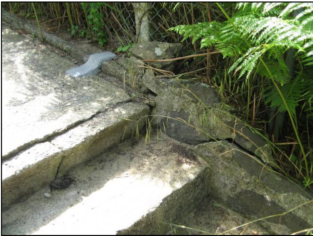
Illustration 13 : Fissuration du chemin bétonné
