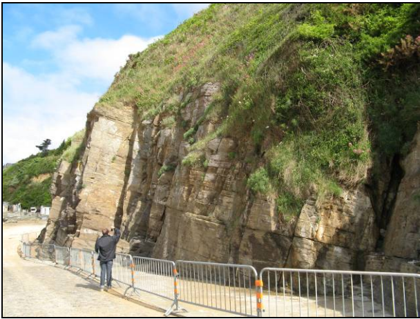
Illustration 5 : Falaise au niveau de la cale d'accès à la plage
