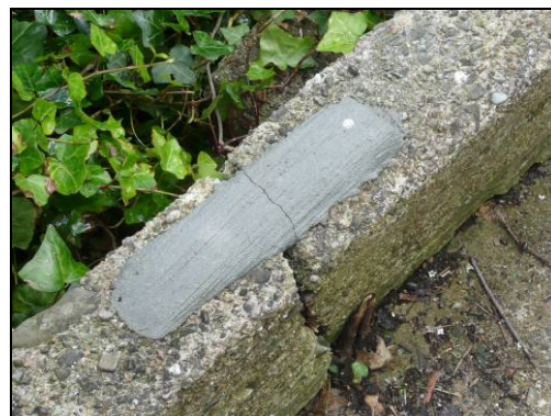
Illustration 14 : Fissure avec témoin de plâtre fissuré
