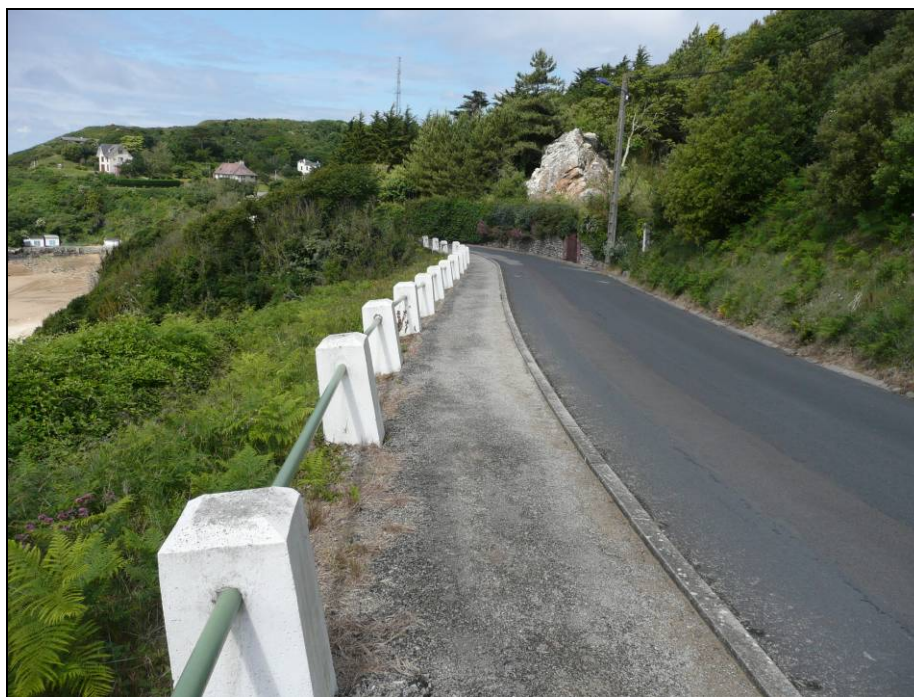
Illustration 12 : Barrière déformée par l'appel du vide
