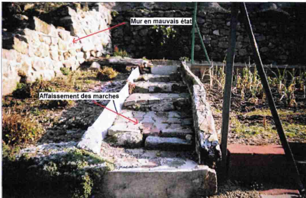
Illustration 9 : Légers désordres sur les terrasses (15 février 2008, photo BRGM)
