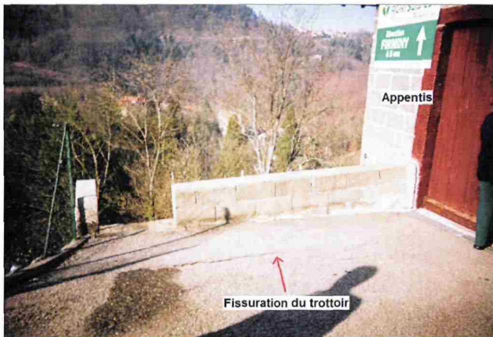
Illustration 5 : Fissuration de l'accotement devant l'appentis (15 février 2008, photo BRGM)
