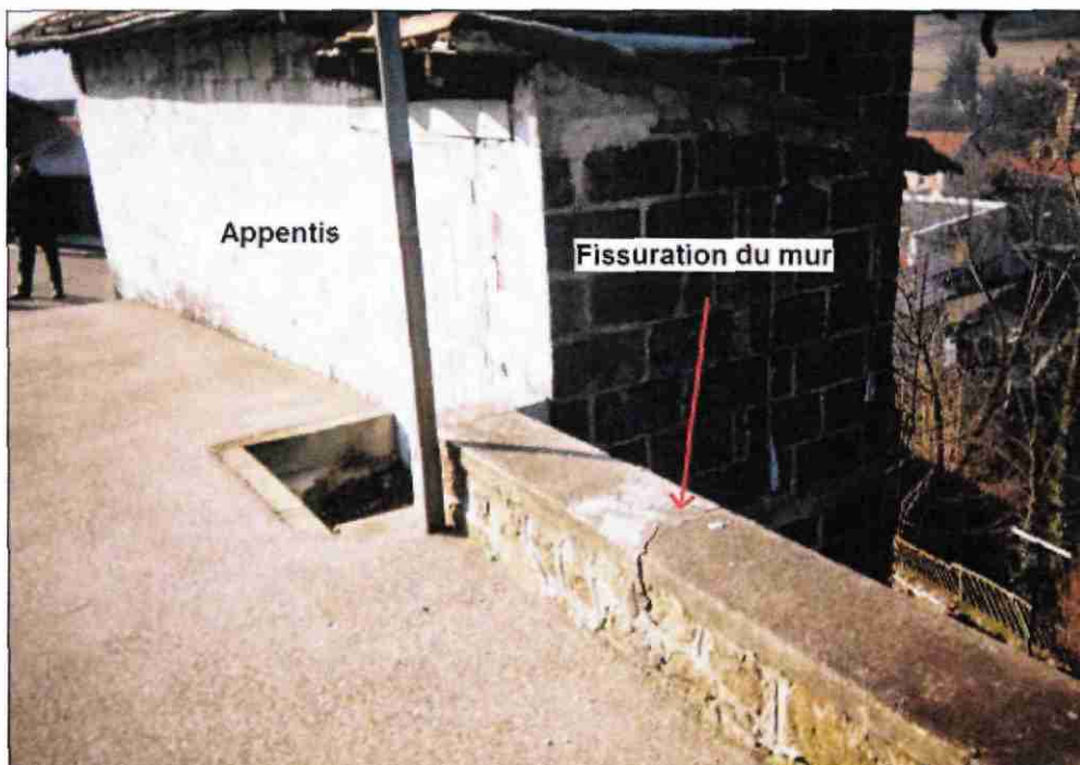
Illustration 6 : Fissuration du mur de soutènement au Nord de l'appentis (15 février 2008, photo BRGM)
