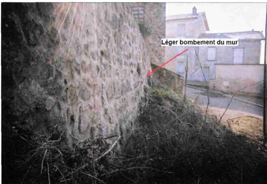
Illustration 10 : Léger bombement du mur de soutènement inférieur avec remblai en terre plaqué en pied (15 février 2008, photo BRGM)
