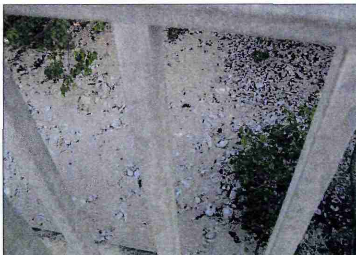
Photo 10 – bras reliant le marigot à la mer obstrué par accumulation de débris rocheux et de sable charriés par les vagues.
