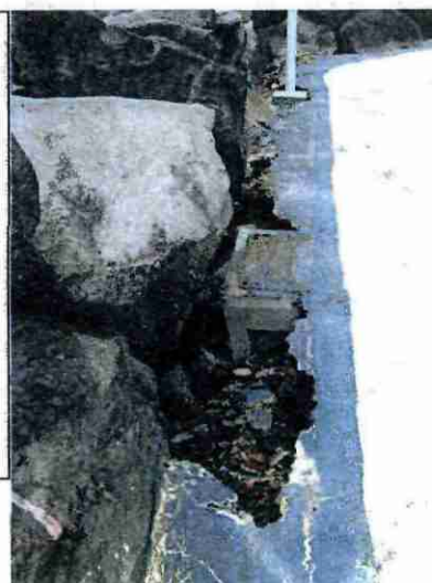
Photo 5 & 6 (à gauche & à droite). Enrobé de la piste cyclable arraché et affouillement du liant des blocs de l'enrochement.
