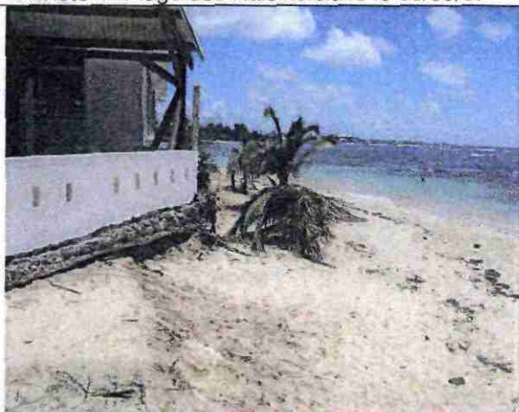
Photo 3- Restaurant endommagé le 08/09/07
