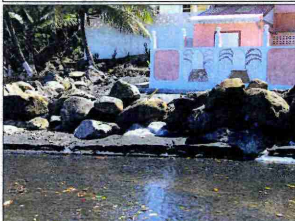
Photo 5 – Enrochement désorganisés en bordure de la ravine à proximité des habitations.
