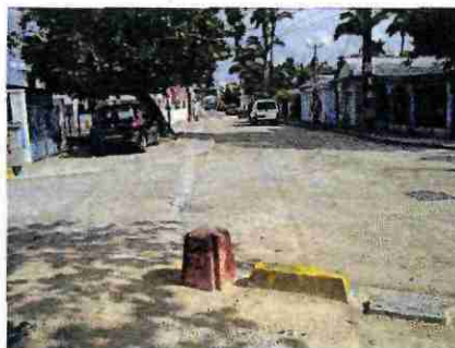
Photo 2- Rue de la plage (encore des traces d'accumulation de sable qui remontent la rue)
