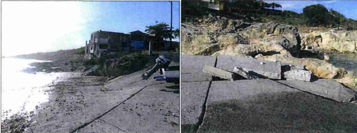
Photo 11 & 12 – Quai de la Petite Anse Kahouanne (à g.) - Dalles en béton endommagées lors de l'impact de la houle au rivage (à d.)
