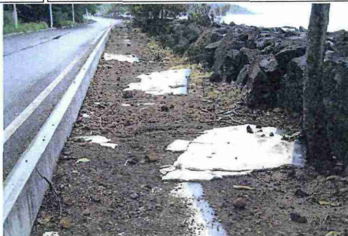
Photo 4 – Piste cyclable endommagée – désolidarisation de plaques d'enrobé.
