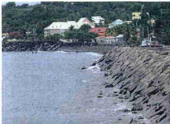
Photo 1 – Enrochement de la RD6.
