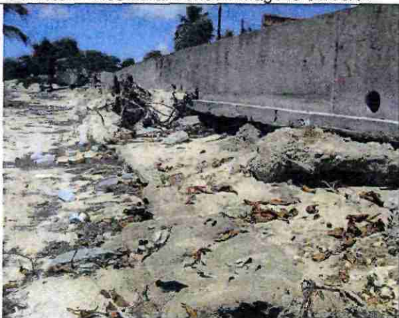
Photo 5- RN4 affouillée le 08/09/07
