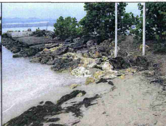
Photo 2- Enrochement endommagé au nord de la plage.
