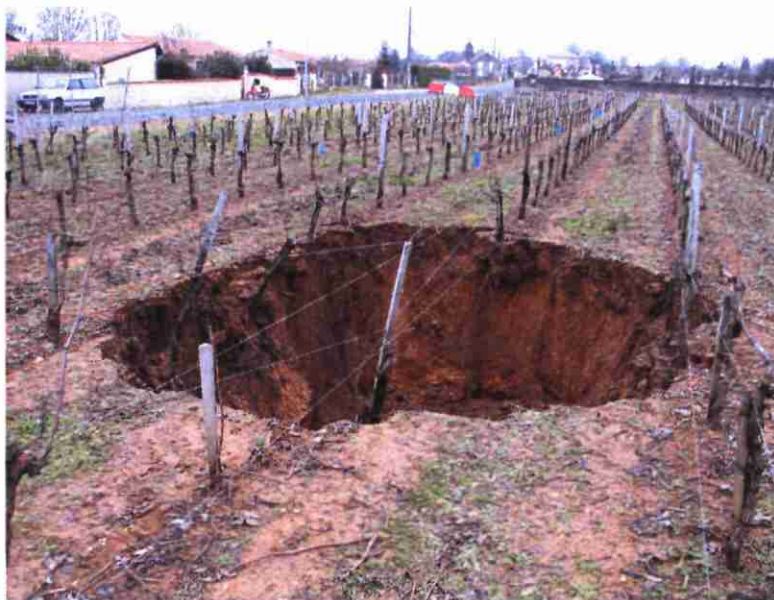
Illustration 17 : Effondrement de terrain à la Gresseuse (commune de Saint-Laurent d'Arce, Gironde) près de la RD 137 E5 le 10 janvier 2006 (source : Bureau des carrières souterraines)
