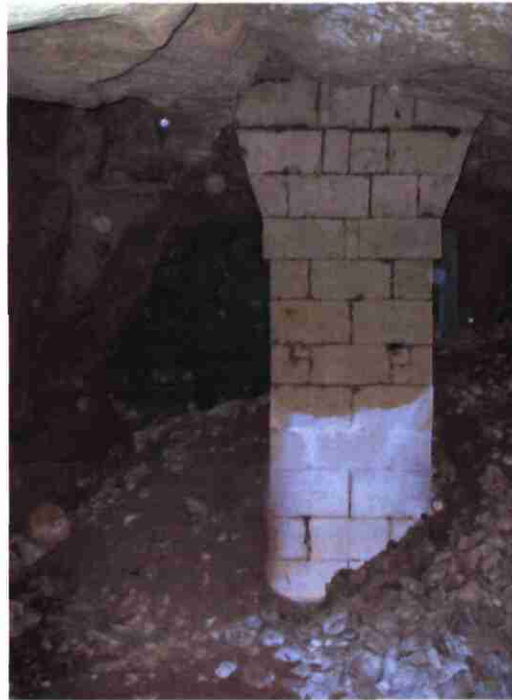
Illustration 27 – Cavité n°17_Nord – Pilier évasé, remblai provenant du remblaiement d'un fontis (côté droit) et mur en parpaings au fond
