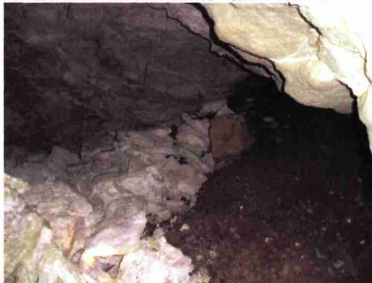
illustration 3 – Cavité n°41 – Rue des Perrières – Chutes du banc de toit et fissuration mécanique résiduelle en périphérie d'un fontis remblayé depuis la surface. Les blocs de craie sont sur les remblais
