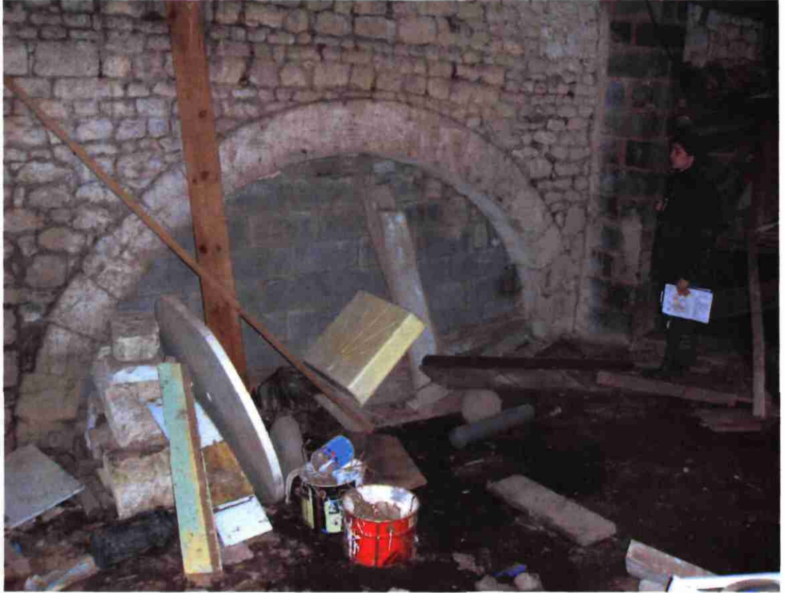
illustration 18 – Cavité n°23 – Photo de la voûte maçonnée
