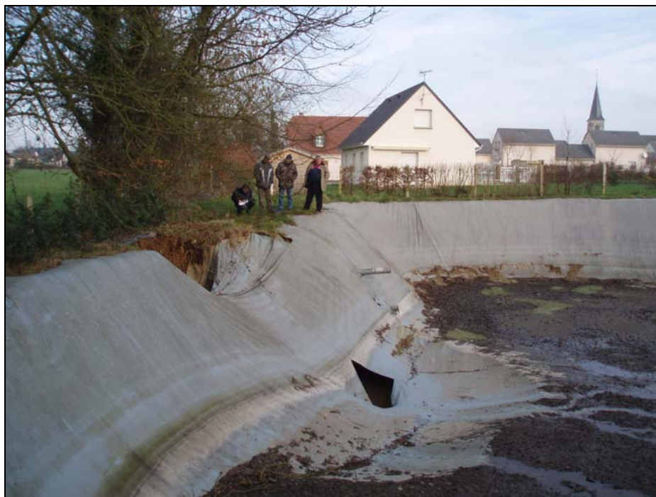
Photo 2 - Vue de l'effondrement depuis le Sud
