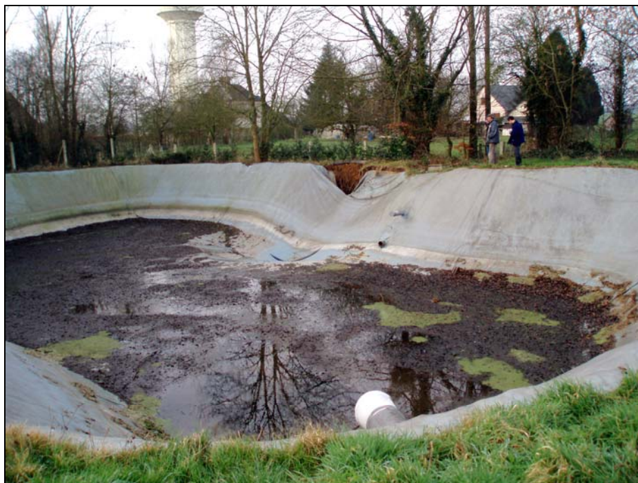
Photo 1 - Vue de l'effondrement, depuis l'accès au bassin
