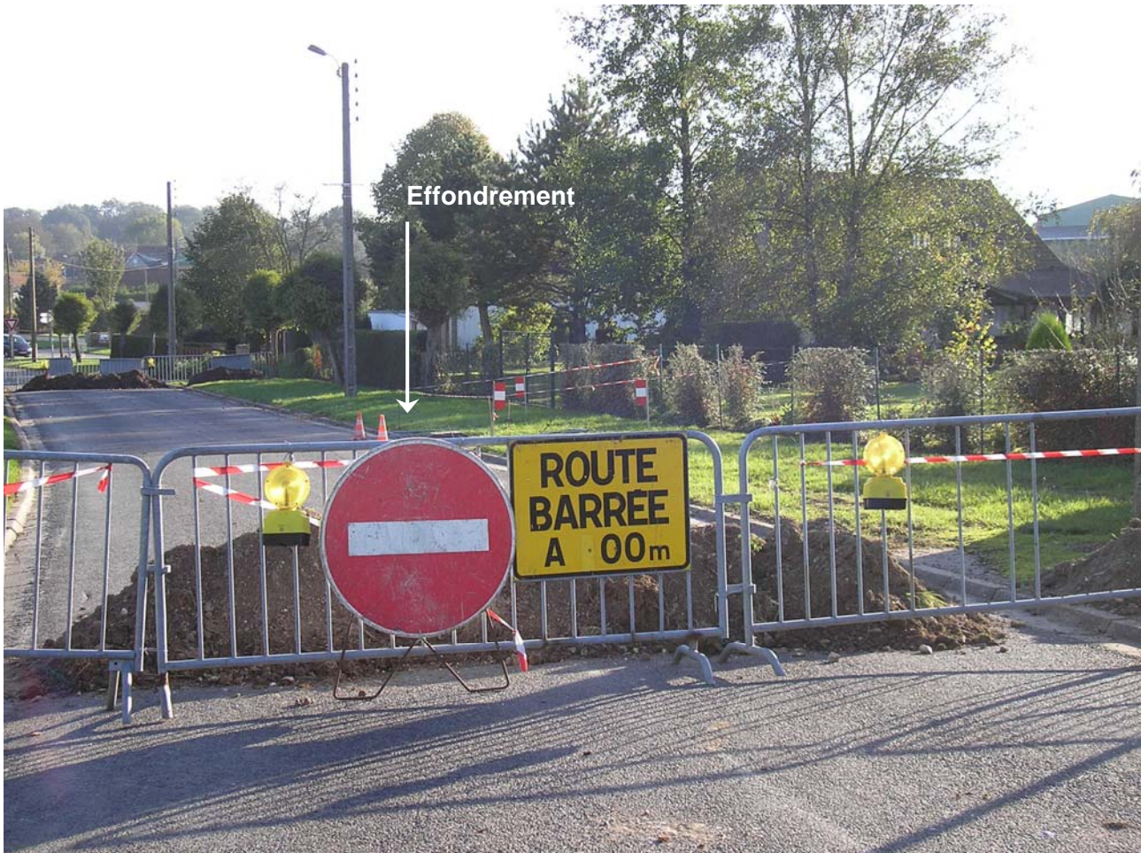
Illustration 3 : la rue du Bout d'aval a été barrée par la subdivision DDE d'Abbeville.
