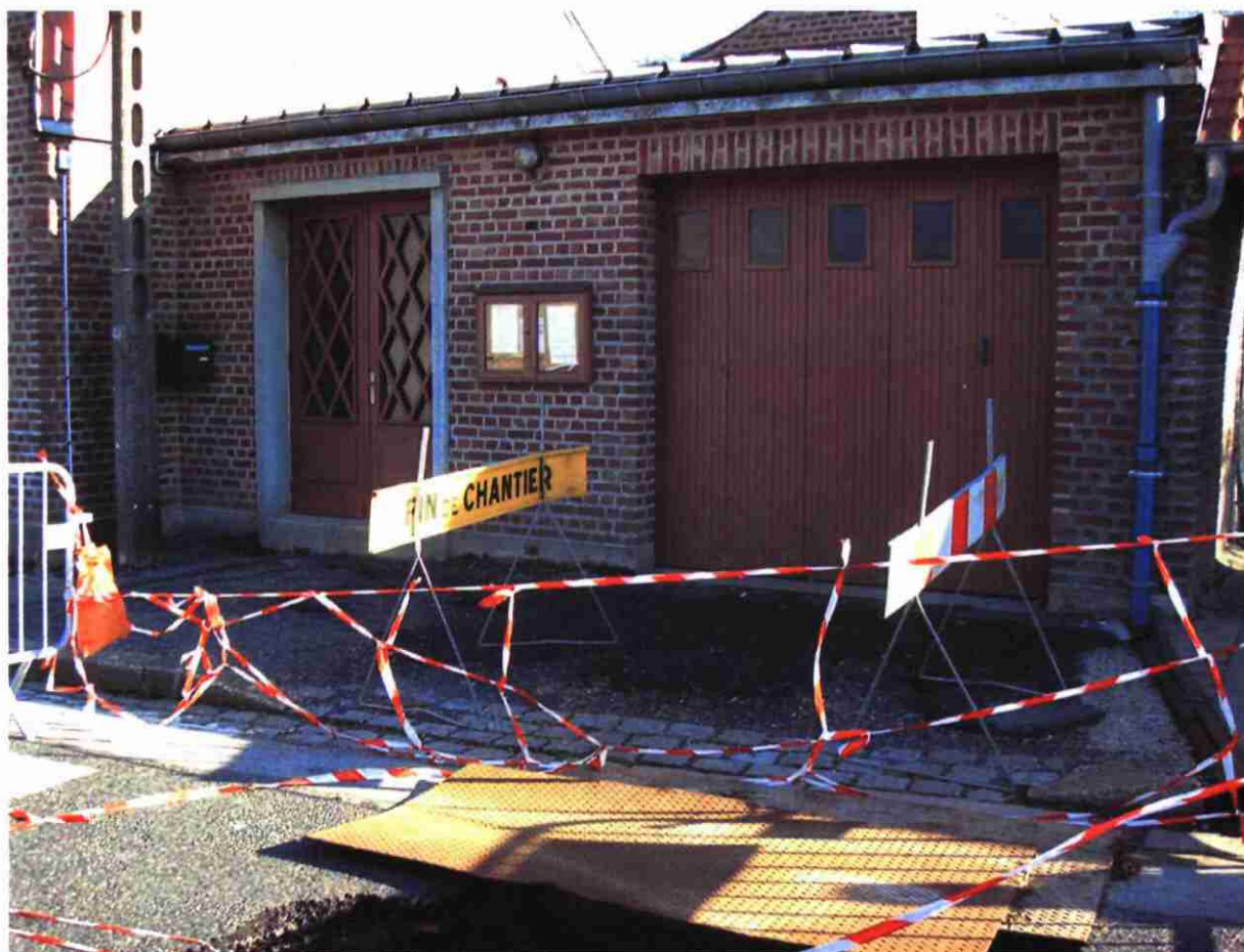
Illustration 4 : la mairie est située à quelques mètres de l'effondrement.
