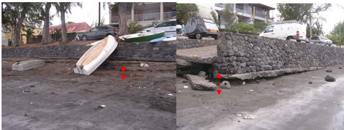
Illustration 46 – Déchaussement du mur de protection
