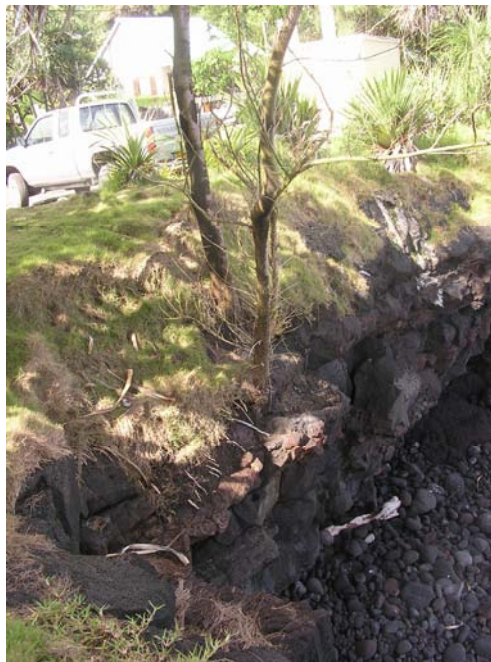
Illustration 28 – Sous-cavage de la falaise de la Mer Cassée à St Philippe
