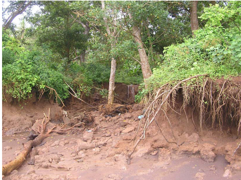
Illustration 14 – Encoche d'érosion régressive liée à la présence d'un cours d'eau (février 2006 – mission BRGM/GEODAL)
