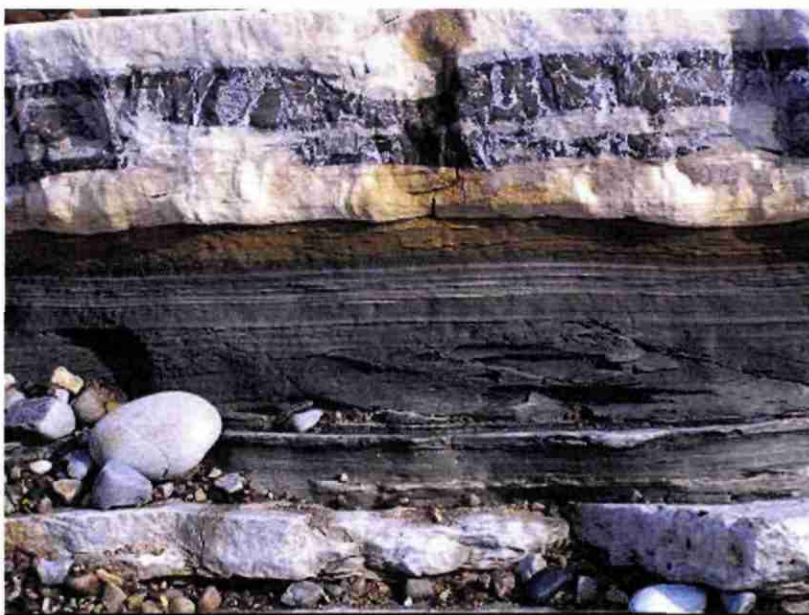
Figure 17 : Oxydation d'interbanc argileux du flysch près de l'interface banc compétent / interbanc argileux. Cette zone oxydée est un témoignage du développement de l'altération.
