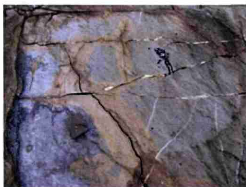
Figure 15 : Anneaux d'oxydation autour de discontinuités à Guéthary
