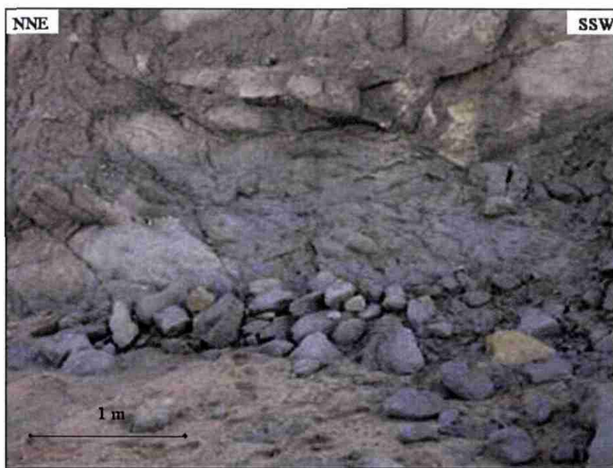
Figure 54 : Eboulements à Ilbarritz (novembre 2004, photo J. Riss)
