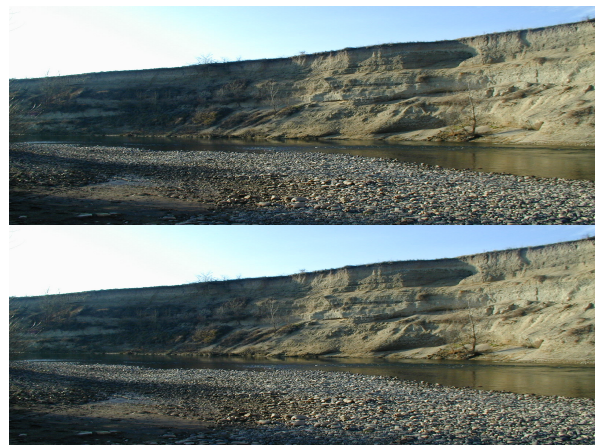
Illustration 11 : Erosion de berge à Cournon – berges de l'Allier
