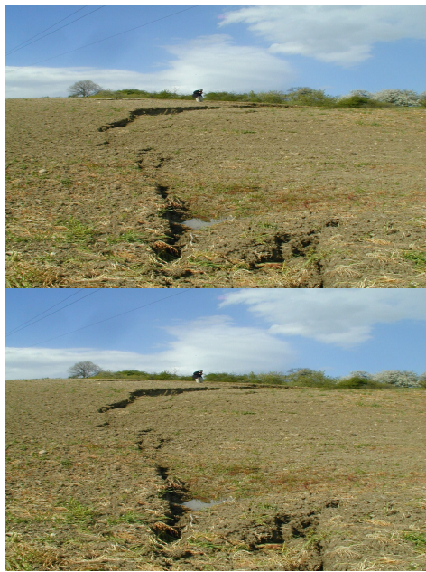
Illustration 8 : Glissement de terrain affectant un pylône haute tension à Saint-Babel
