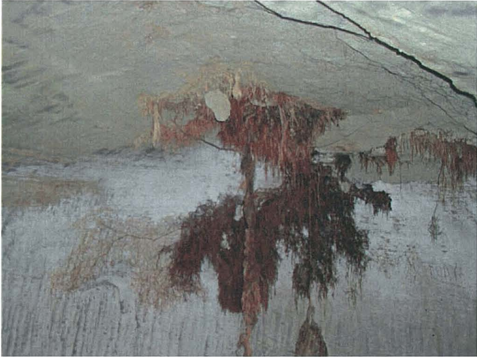
Illustration 44 : Racines pénétrant à l'intérieur du souterrain de Saint-Martin situé sur la commune de Ferrensac
