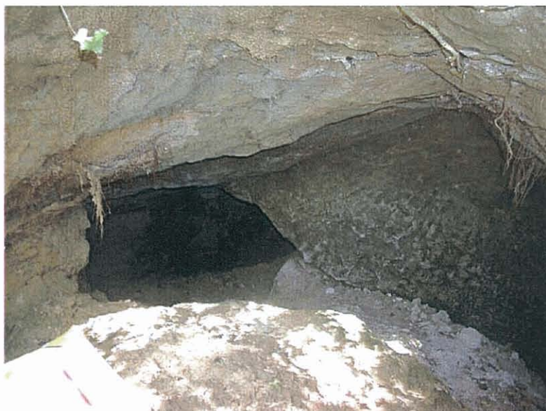
Illustration 14 : Accès effondré du Souterrain refuge de la commune de Bournel au lieu-dit les Nauvettes dans le Lot-et-Garonne (47)
