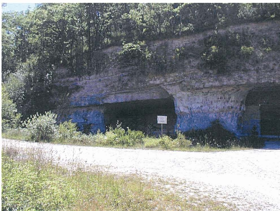
Illustration 3 : Carrières souterraines abandonnées utilisées actuellement comme zone de stockage par le propriétaire à Saint-Front-Sur-Lémance au lieu-dit La Toueille
