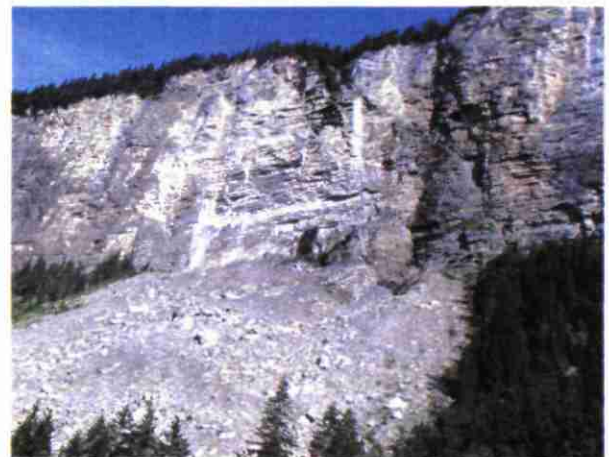
III. 11 - Eboulement de versant généré par l'effondrement d'une ardoisière (lieu-dit « les Avinières » à Morzine)
