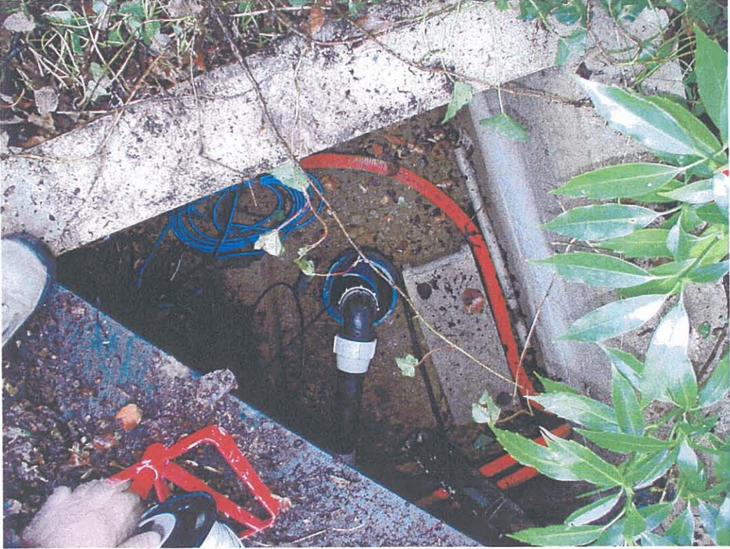
Forage accessible malgré l'équipement de la pompe
