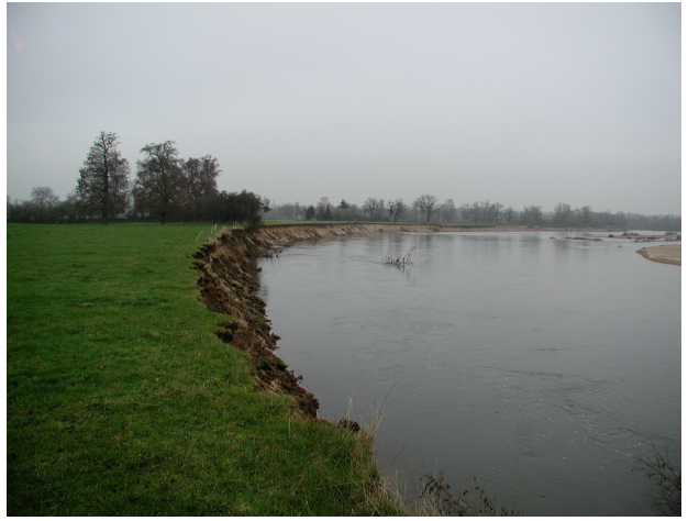
Illustration 10 : Erosion de berge à Beaulon, berges de la Loire
