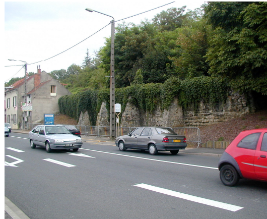
Illustration 8 - Glissement de terrain du parc de Montbéton à Cusset, renversement d'un mur à contreforts
