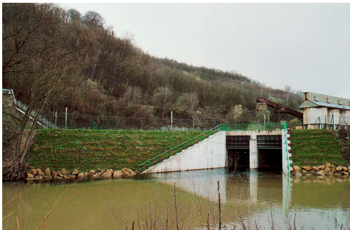
Photo 2 : Nouveau point de débordement à la sortie du chenal en fonction depuis fin 2003
