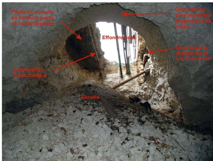
Illustration. 12 : Trottoir en console en limite ouest de l'effondrement
