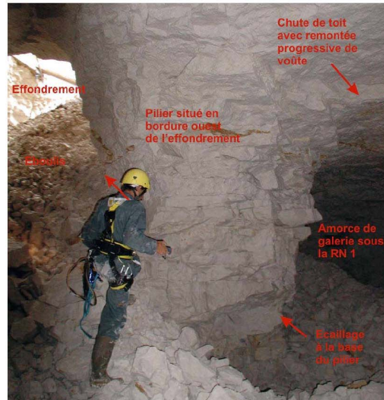
Illustration. 10 : Pilier situé à l'ouest de l'effondrement avec extension des vides sous la RN 1
