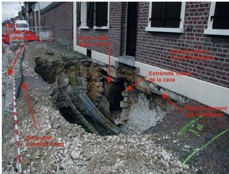
Illustration. 3 : Déchaussement des fondations sous la maison située 16 rue St-Antoine
