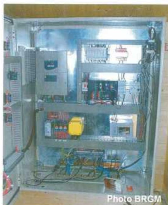
Armoire électrique de Bois de Ville
