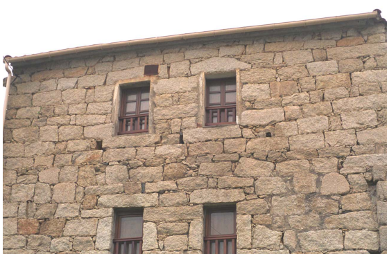
Photo 109 - San Gavino di Carbini : maison ; noter l'éclat de boule au-dessus d'une fenêtre
