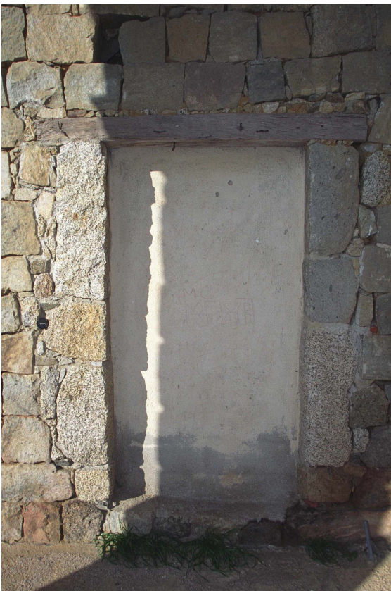
Photo 29 - Sainte-Lucie : couvent Saint- François ; mur du rez-de-chaussée
