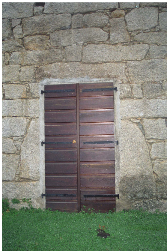
Photo 108 - San Gavino di Carbini : même maison que la photo 97. Noter les éclats de boules de chaque côté de la porte
