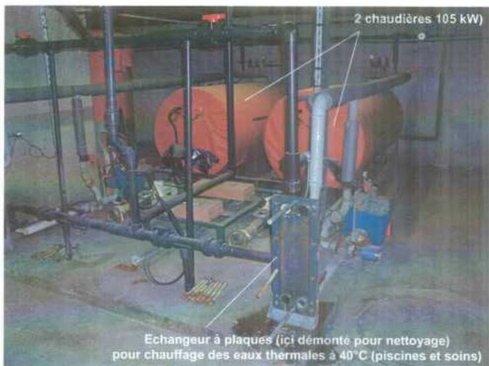
Chauffage des eaux thermales à 40°C sur échangeur à plaques
