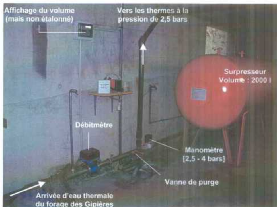
Système de mise en pression à 2,5 bars du circuit des eaux thermales dans l'établissement
