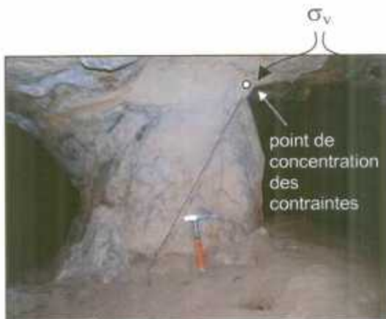
Figure 14 - Cisaillement d'un pilier dans une carrière de grès à Sainte Paule
