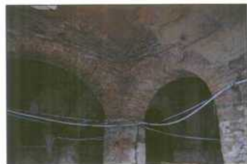
Figure 15 - Confortement de la voûte dans une carrière de molasse de Saint-Fons
