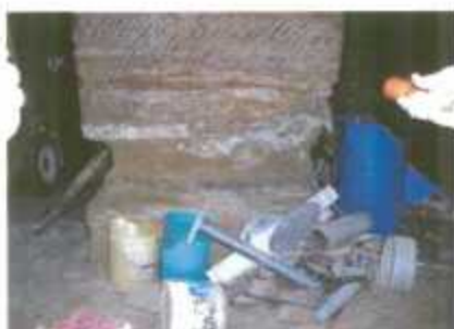
Figure 16 - Sous-cavage d'un pilier dans une carrière de Saint-Fons
