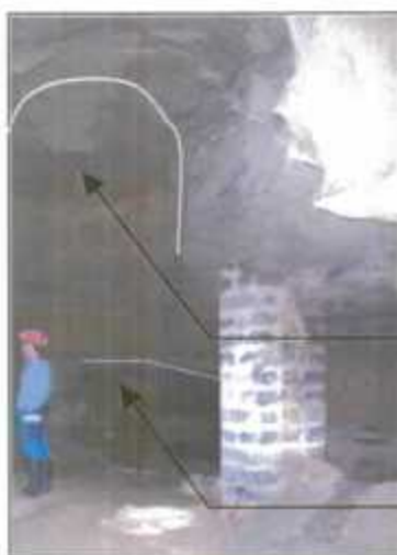
Figure 17 - Confortement de la voûte et progression d'un fontis dans la carrière de Toussieu
