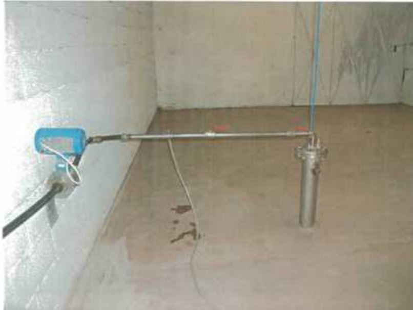
Figure 20 - Tête du puits "Brault 3 nouveau" (ex-Château, ex- Brault n°2) de Sail sous Couzan et piquage d'échantillonnage sur le pompage en continu.
