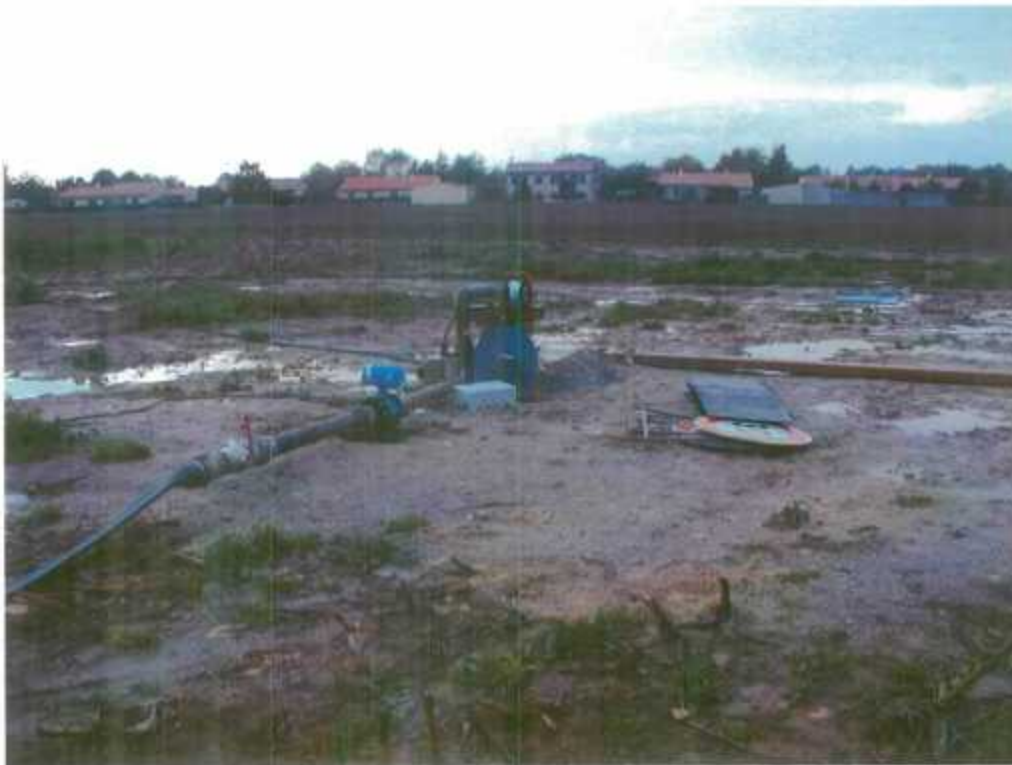
Figure 7 : Equipement de l'ouvrage pour les essais.
