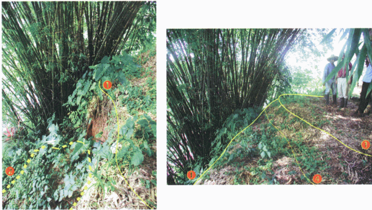
Figure 9 : Glissement de talus récent vu de la crête du talus (gauche) et présentant des signes de décrochement potentiel (droite). ① tête de talus actuelle, ② sommet de la zone éboulée et ④ limite de la zone de décrochement potentielle.
