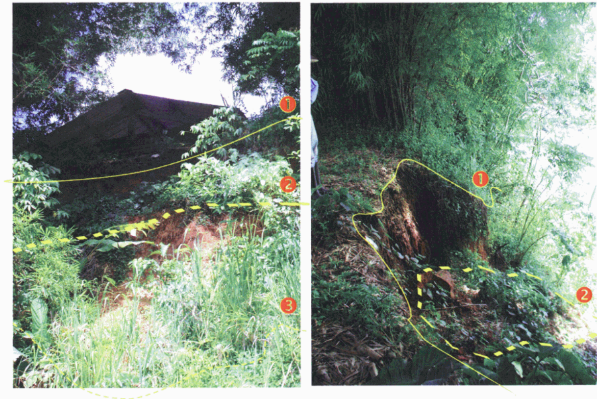
Figure 8 : Glissement de talus récent vu de la RD11 (gauche) et de la crête du talus (droite). ① tête de talus actuelle, ② sommet de la zone éboulée et ③ sabot de la zone éboulée.
