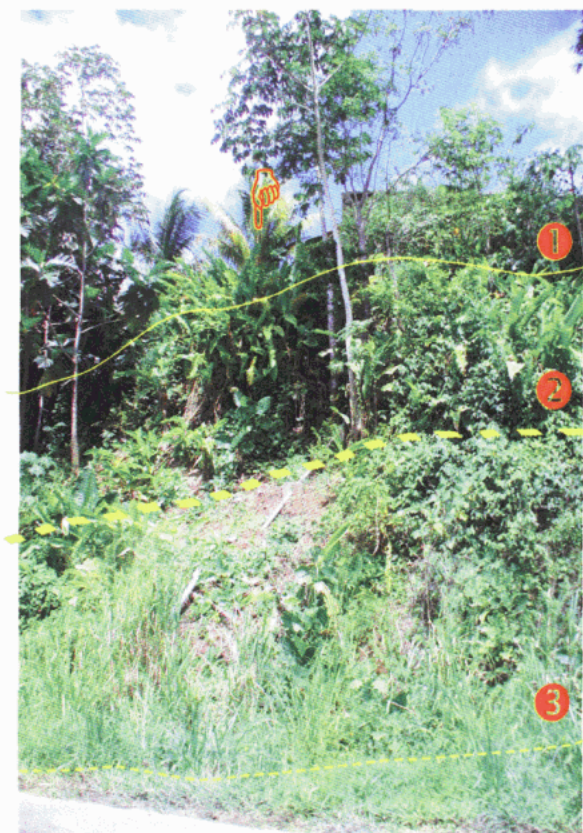
Figure 6 : Talus de la RD 11 avec zones éboulées. ① tête de talus actuelle, ② sommet de la zone éboulée et ③ sabot de la zone éboulée ; la main (P) indique le palmier repère
