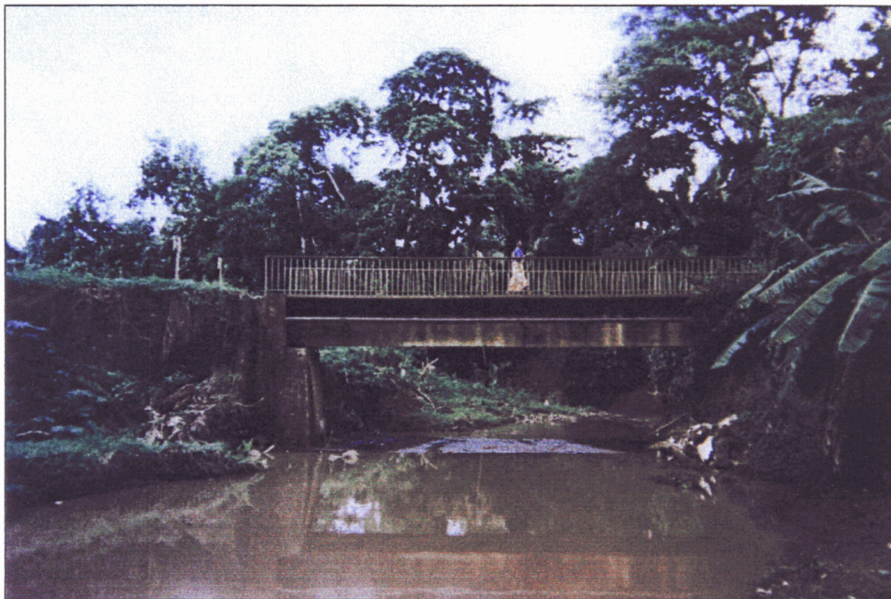
Photo 11 : Village de Bouyouni, ouvrage de franchissement de la RN1. Embâcle en rive droite Photo Olivier Jossot, BRGM Mayotte, le 18 février 2003.
