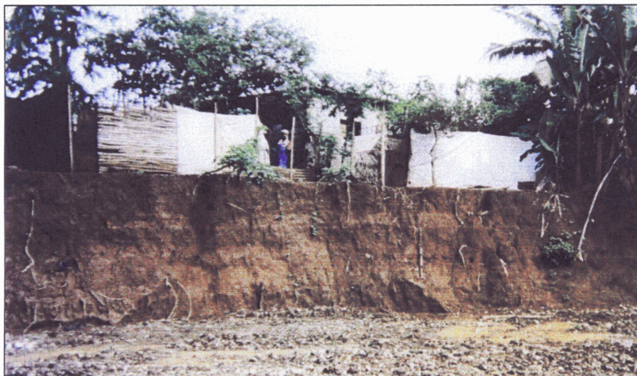
Photo 10 : Village de Bouyouni, zone amont pont. Exemple d'excavation de berges due à l'érosion. Photo Olivier Jossot, BRGM Mayotte, le 18 février 2003
