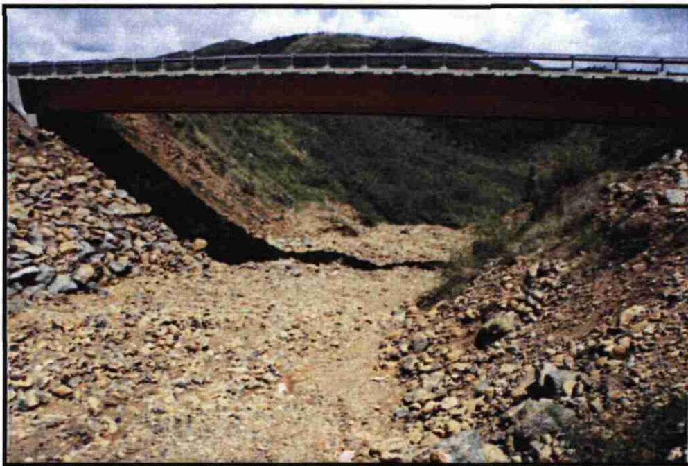
Fig. 69 – Franchissement actuel du creek Jeanne et Marie sur la RP 4
