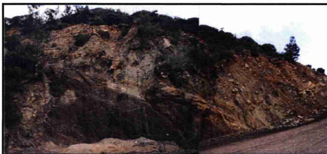
Fig. 64 – Glissement du Piton de Pandop : Détail du contact de base en bordure de la piste
