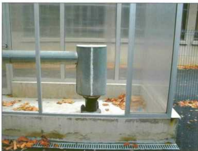
Photo5 : Tête de forage de la source Auraline protégé par un périmètre sanitaire d'émergence
