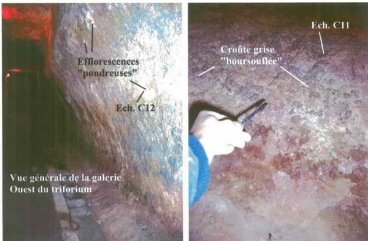
Photos 47 et 48 - Eglise médiévale - Triforium - Croûtes grises "boursoflées" - Efflorescences blanchâtres "poudreuses".
