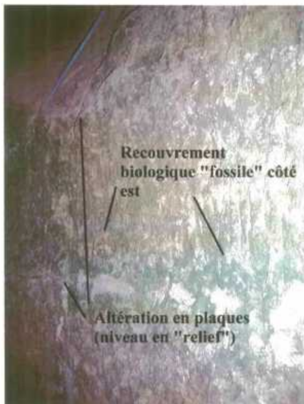
Photo 31 - Eglise médiévale - Abside - Recouvrement biologique verdâtre (algues) "fossile" côté est - Niveau en "relief" (à altération en plaques et feuillets).
