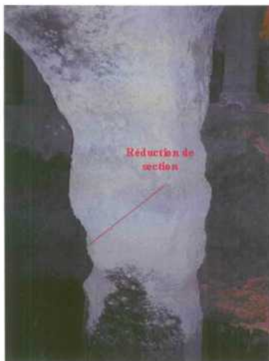
Photo 12 – Pilier Nord – réduction de section du à l'écaillage
