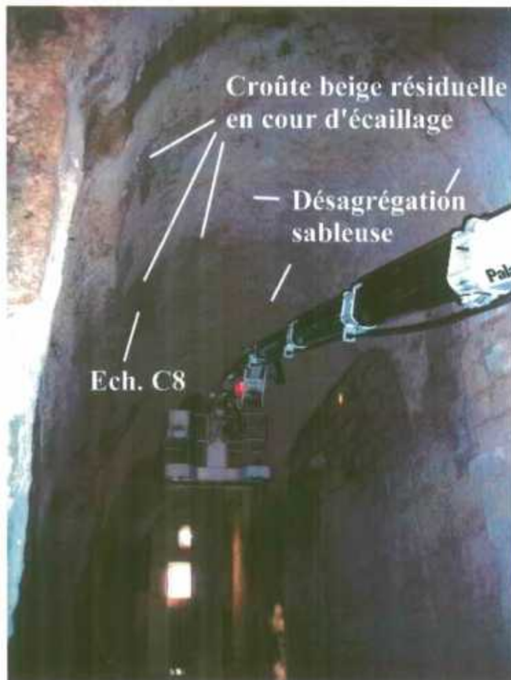
Photo 43 - Eglise médiévale - Façade Est - Transept nord - Voûte à croûte beige en décollement - Désagrégation sableuse dans les zones "décollées" - Recouvrement d'algues dans les zones plus humides (paroi et voûte côté nord).
