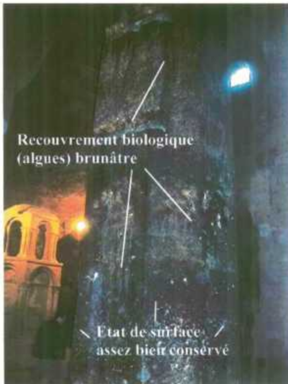
Photos 35 & 36 - Eglise médiévale - Piliers "centraux"- Partie intermédiaire à surface bien conservée - Zone de remontée capillaire avec altération en plaque "fossile".
