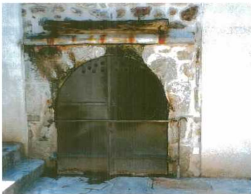
Photo 4 : Captage de la source du Par
