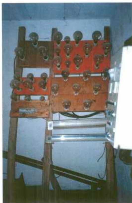
Photo 13 : Panneau test d'éclairage
