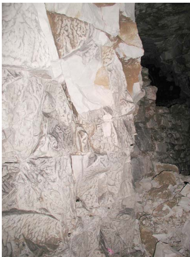
Fig. 13 – Fracturation d'un pilier dans la galerie Porte Becquerelle
