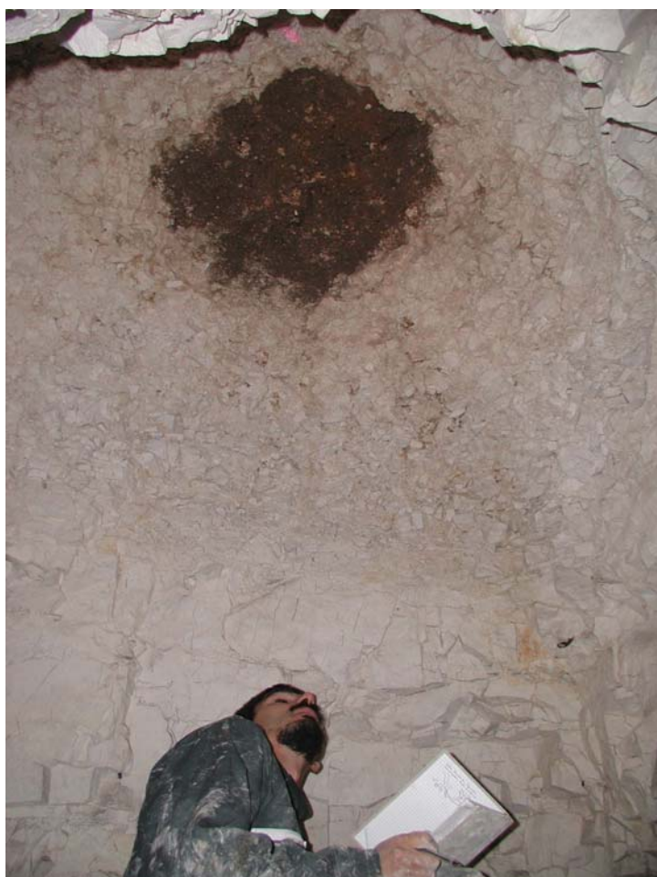
Fig. 15 – Montée de voûte observée en galerie sous le 7, rue Cauvel de Beauvillé
