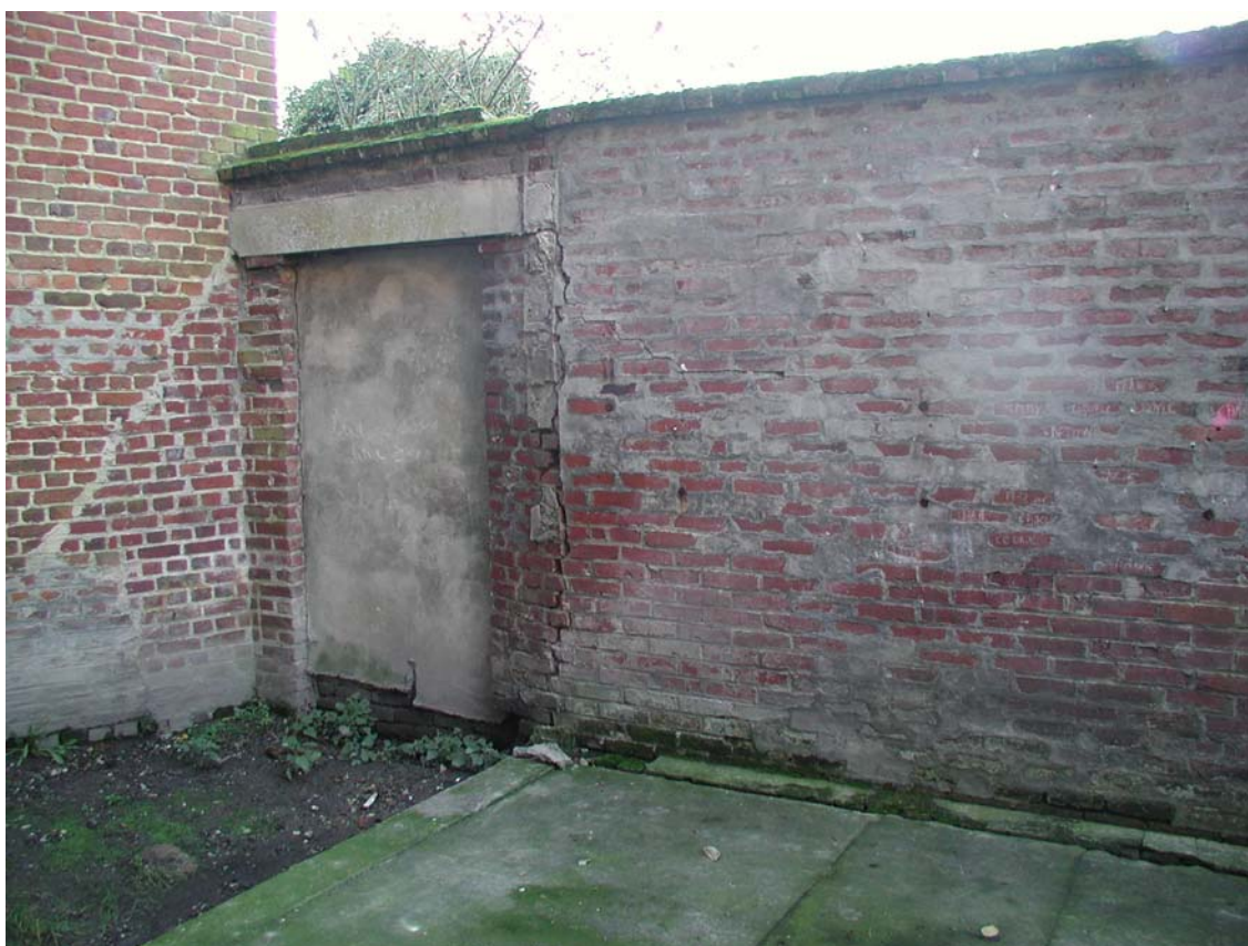
Fig. 12 – Fissuration des murs de clôture derrière la maison au 7, rue Frézon
