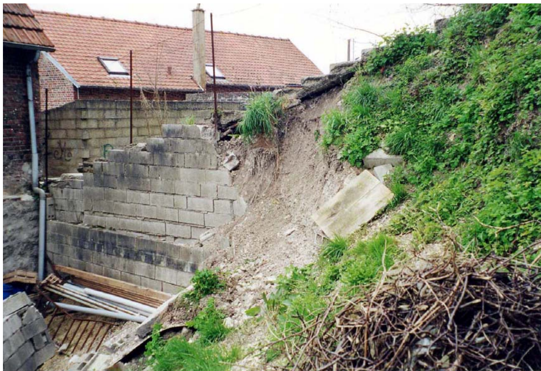
Fig. 5 – Effondrement d'un mur poussé par un glissement de terrain (chemin public du Prieuré)
