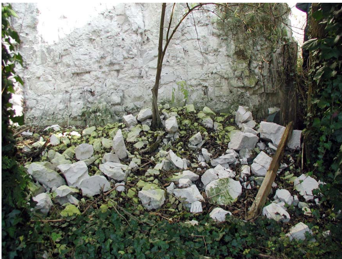
Fig. 6 – Eboulement de blocs en pied de falaise au 10, rue Saint Martin
