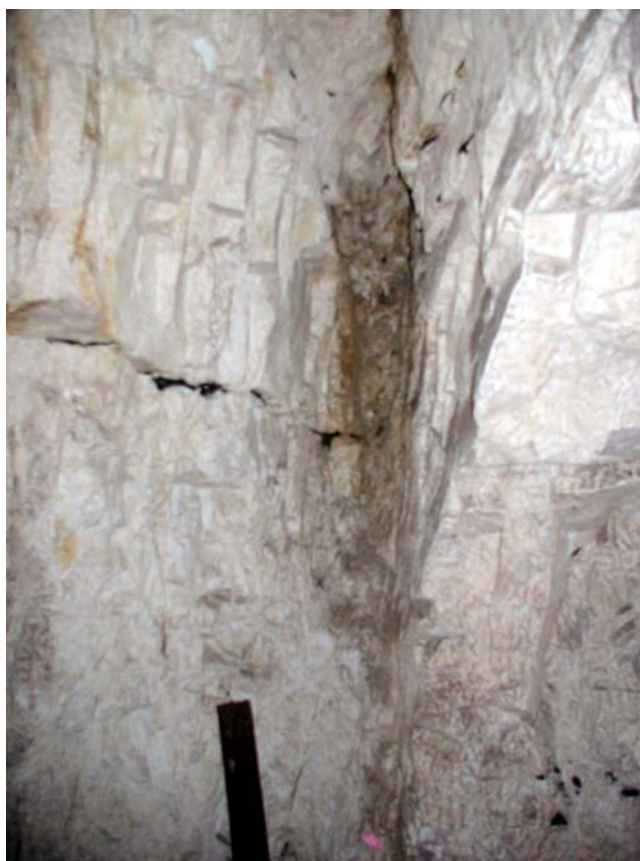
Fig. 10 – Diaclase verticale parallèle à la falaise, à l'intérieur d'une cave en pied de falaise au 6, rue Saint-Martin
