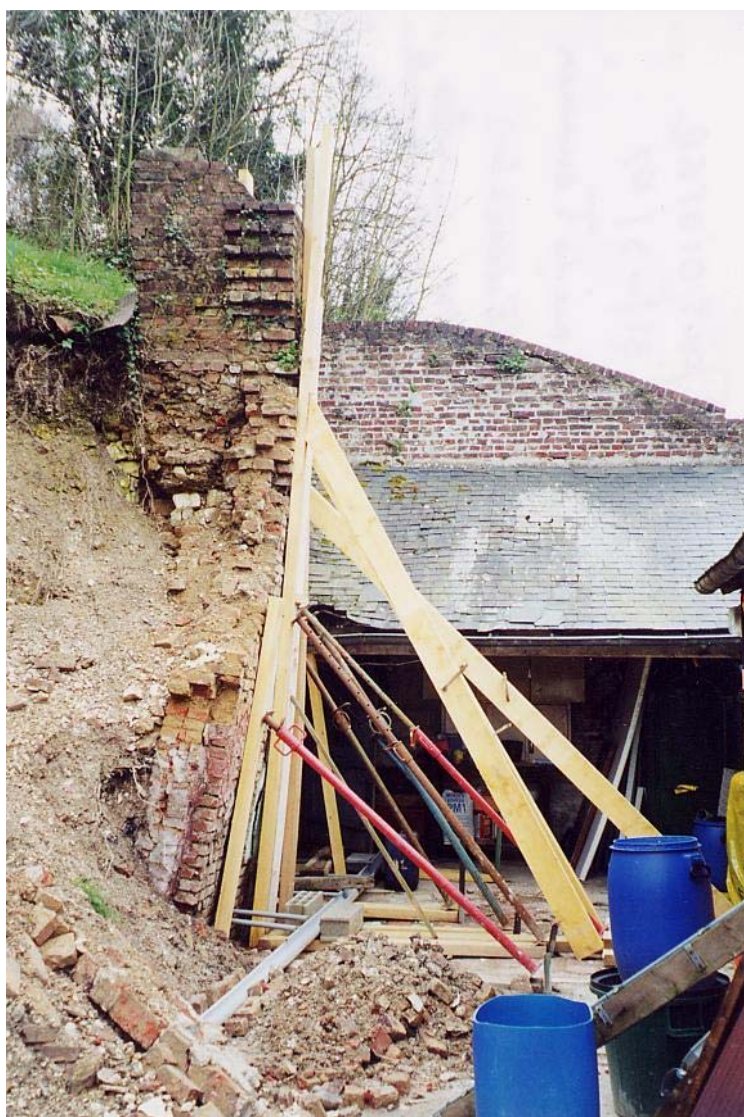
Fig. 19 – Rupture d'un mur de soutènement en pied de talus, 44 rue des Tanneries
