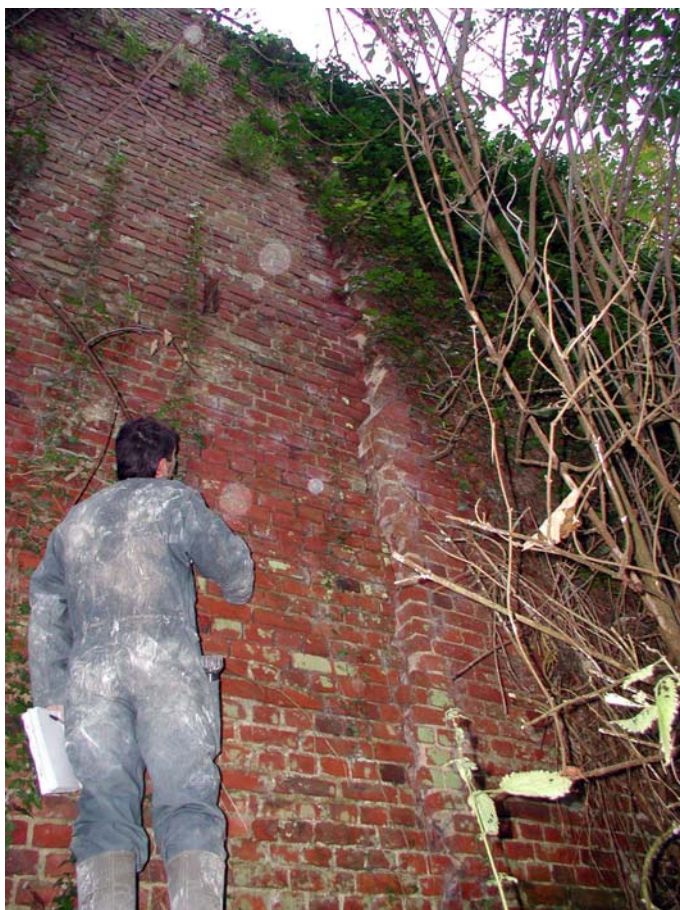
Fig. 22 – Décrochement d'une vingtaine de centimètres du mur situé entre les parcelles AI 41 et AI 803b
