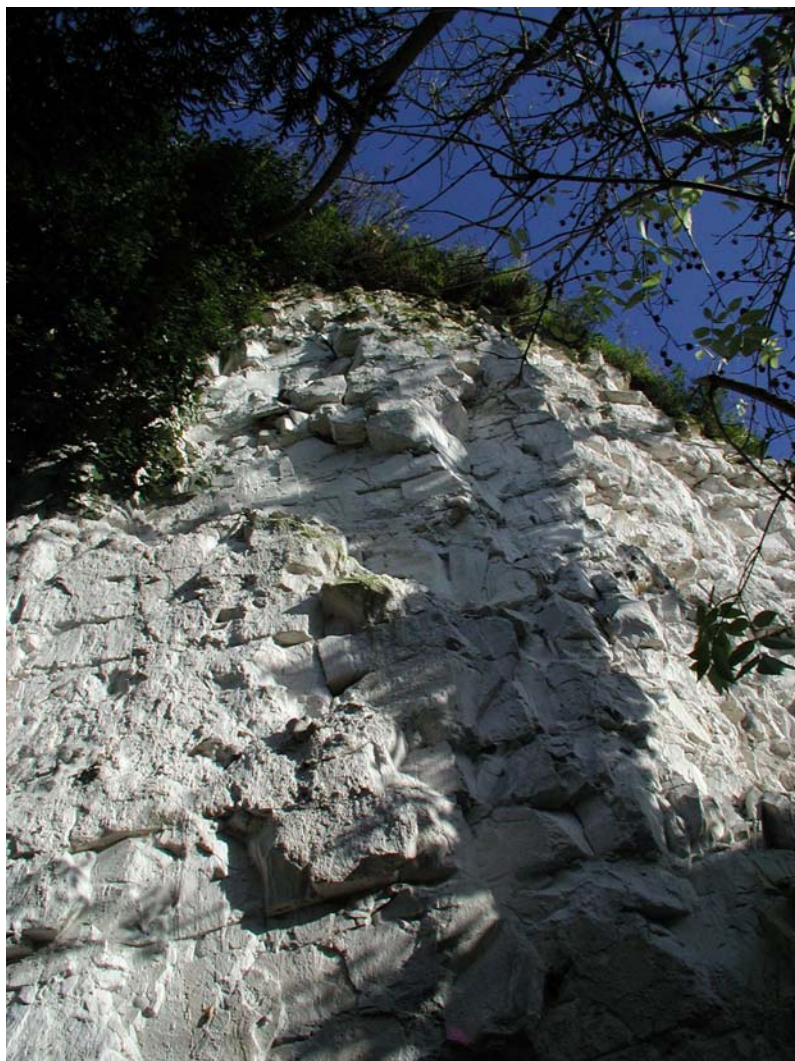
Fig. 7 – Blocs partiellement détachés en tête de la falaise au 10, rue Saint Martin
