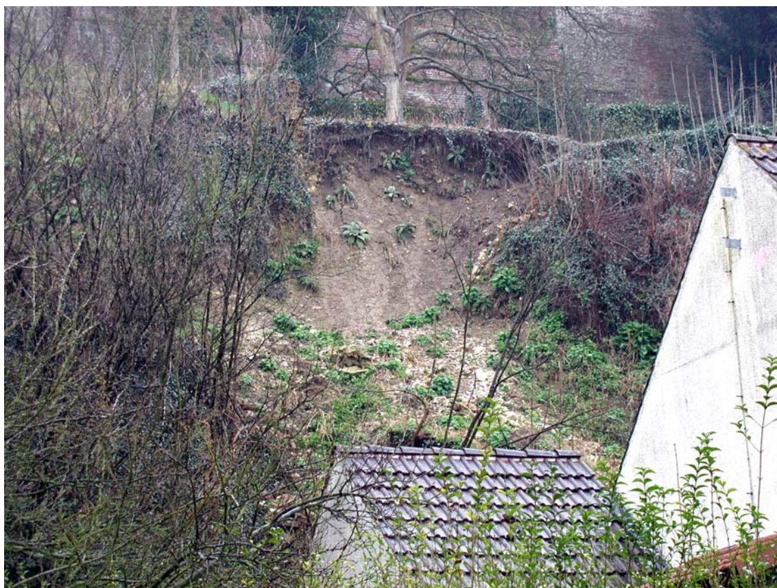
Fig. 20 – Glissement de terrain dans le versant du coteau, 44bis rue des Tanneries
