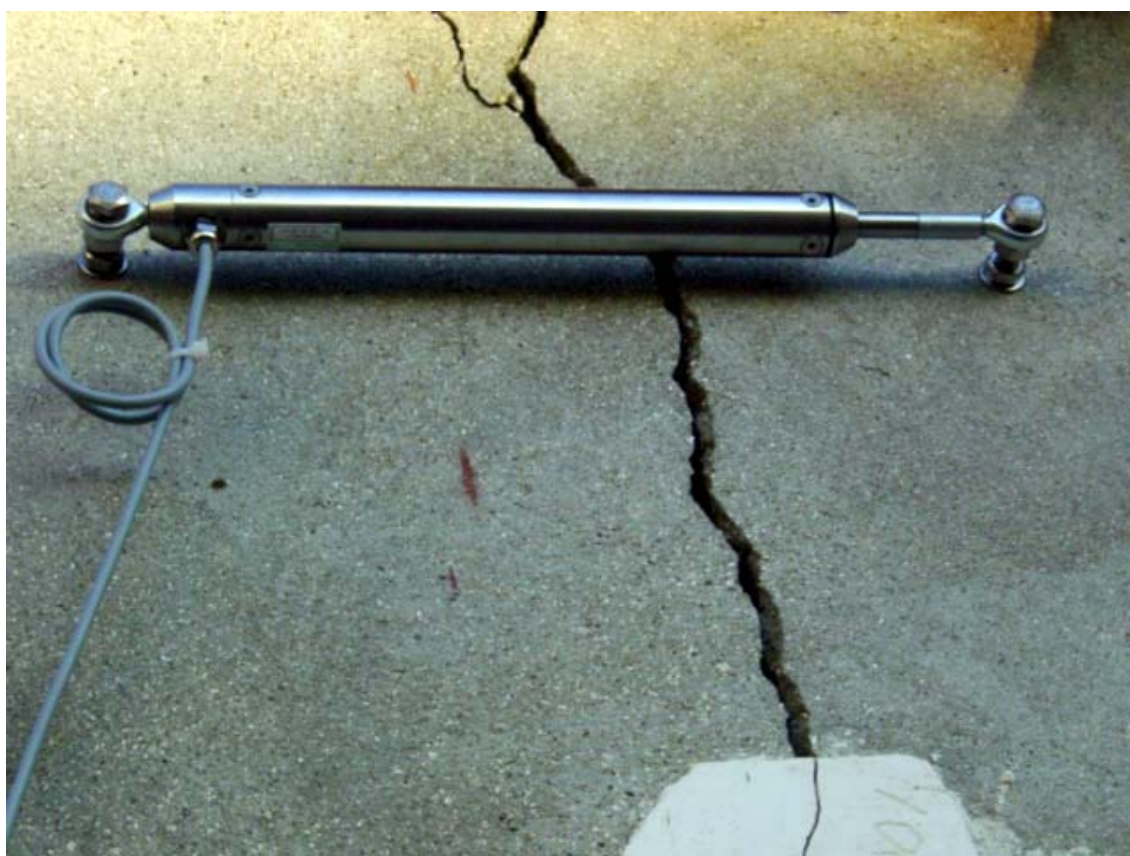
Fig. 24 – Capteur de déplacements (type 2) situé au coin du mur de l'annexe du collège Saint Vincent (7 rue Cauvel de Beauvillé)
