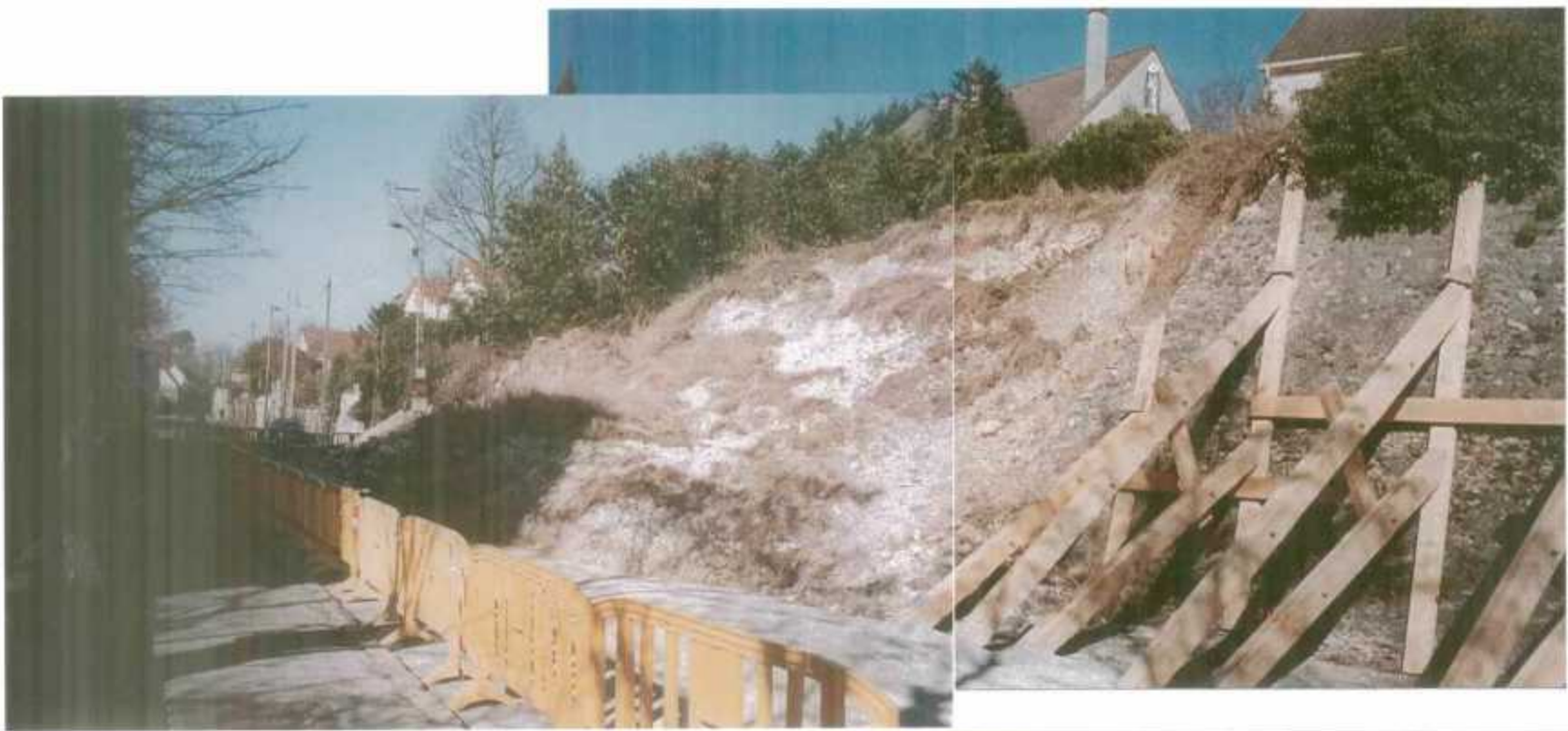
Photo 1 - Vue du glissement depuis la RD 947
