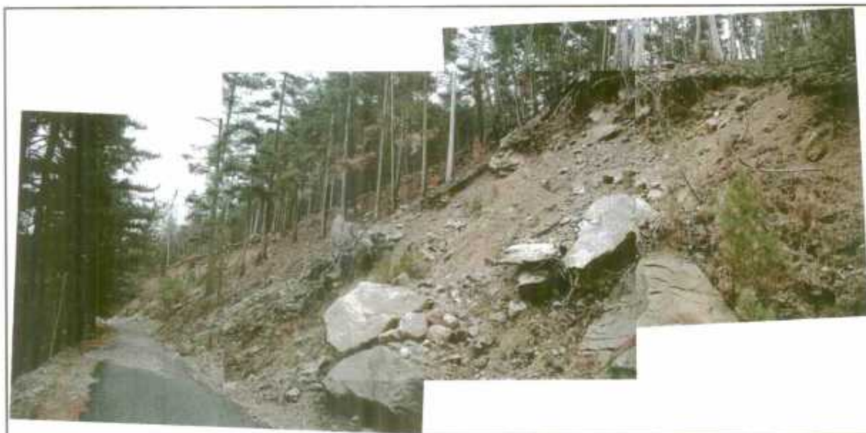
Zone d'aléa chute de blocs élevé
