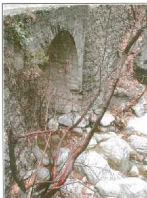
Léger affouillement de la culée rive gauche aval.
