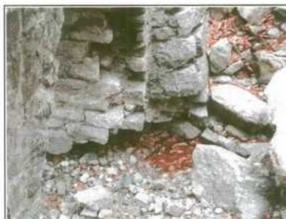
Affouillement de la culée rive droite amont.
