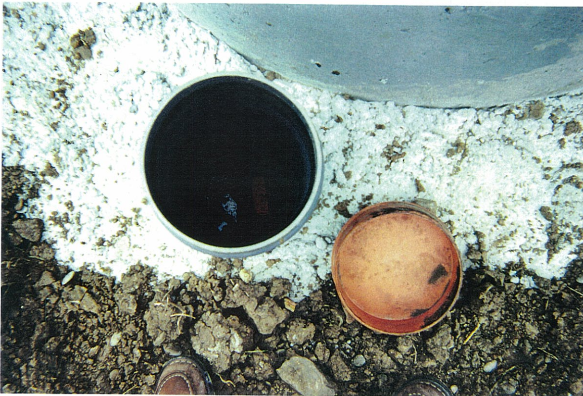
Photo 16 - Vanne sur tuyau d'évacuation.
