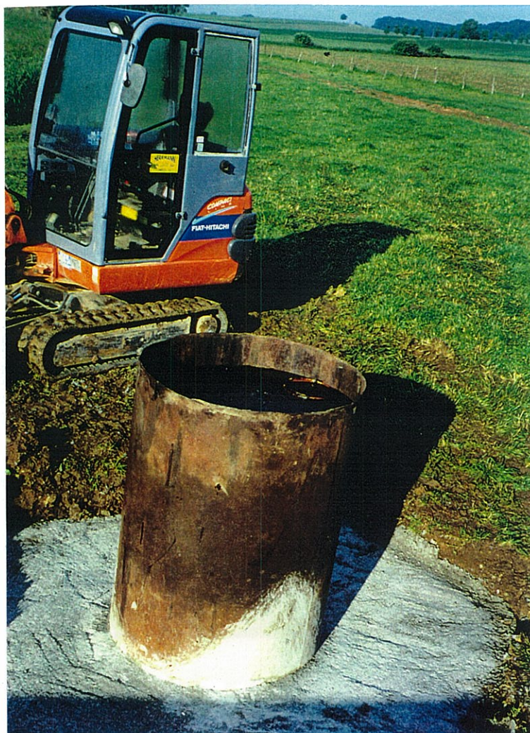
Photo 14 - Le 26 mai 2000, à 7 h 30, vue sur le massif de béton : le liquide est remonté pendant la nuit et s'est stabilisé à 1,1 m au-dessus du ciment, soit à 15 cm du bord de la virole.
