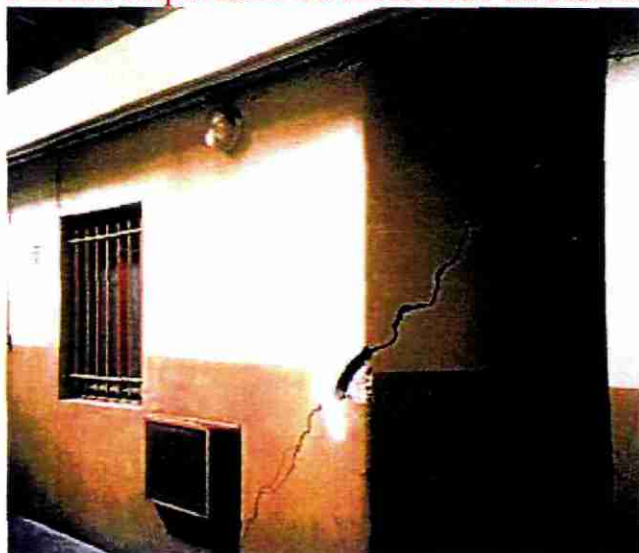
Immeuble Lachenal à Annecy Fissure importante du local situé au RdCh.
