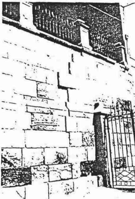
Basculement d'une partie du parvis de la cathedrale.
