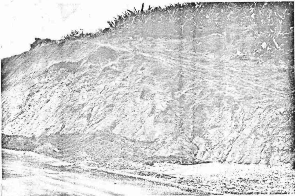
Photo 2 - Déblai D4 Nord Glissement P 198
