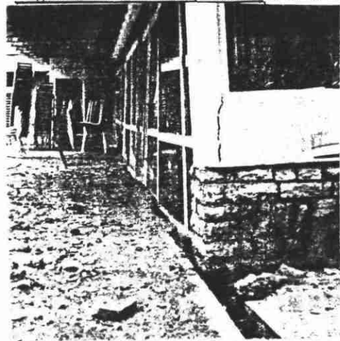
e. Détail montrant l'enfoncement des fondations de l'hôtel (photo P. GODEFROY, B.R.G.M. Orléans)
