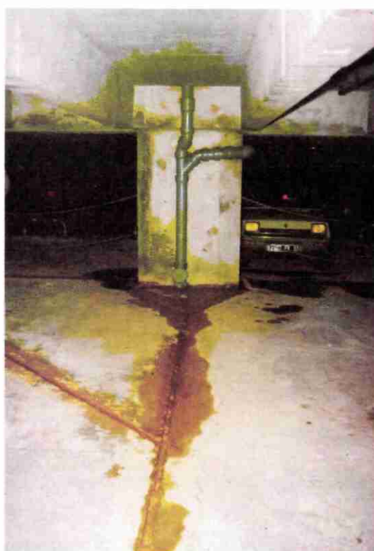
Figure 7 c - Place de La Madeleine : Venues d'eau à la liaison radier - pilier de soutènement
