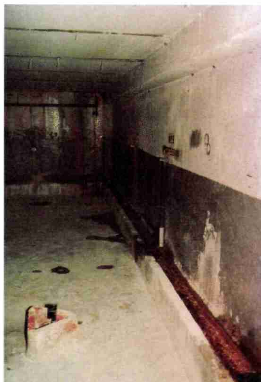
Figure 8 c - Parking dans le haut de l'avenue de Neuilly : drains de décharge de la nappe et traces de ruissellement laissant apprécier l'ampleur du phénomène
