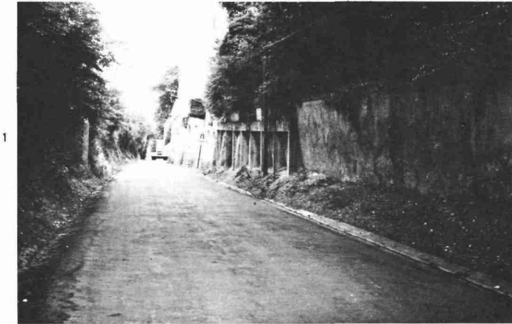
Désordres dûs au fluage du Sénonien argilo-siliceux et des calcaires lacustres de Touraine (Fondettes, Indre et Loire)
