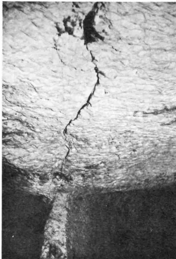
Fissure du toit dans l'axe d'un pilier long (carrière de St Georges, Roche carbon, 37)
