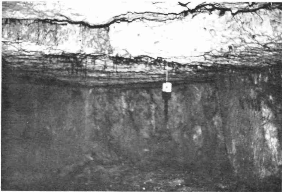
Carrière de St Georges : jeu de fractures responsable de la chute du premier banc constituant le toit (Roche carbon, 37)
