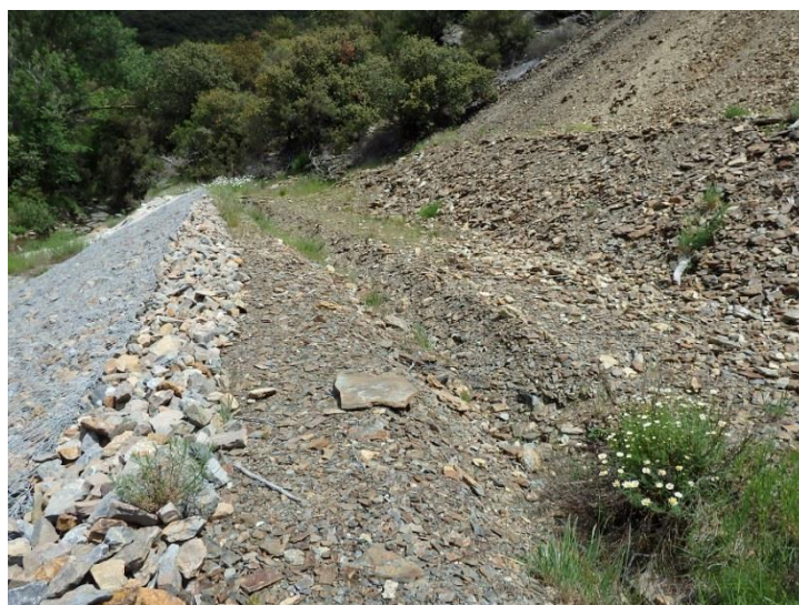
Illustration 49 - Fossé entre le pied de verse et la digue - avant crue (23/05/2018).
