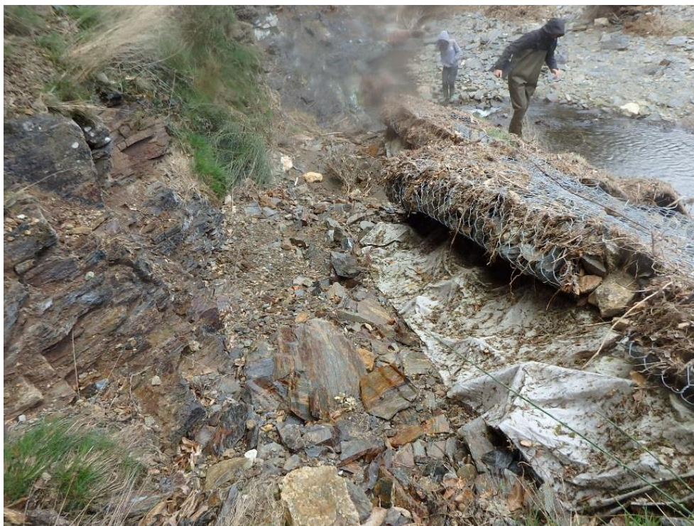
Illustration 56 - Gabions endommagés par la crue en partie terminale de la digue (21/03/2019).
