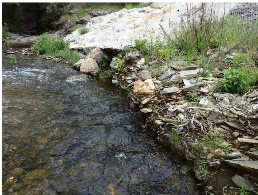
Illustration 58 - Sous-cavage au niveau des enrochements bétonnés - avant crue (23/05/2018).
