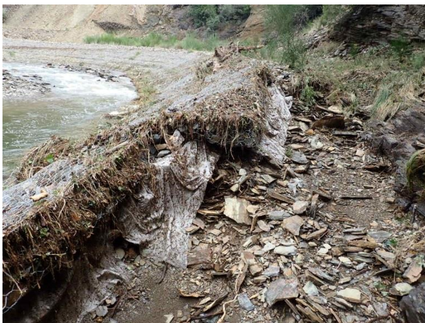
Illustration 55 - Gabions endommagés par la crue en partie terminale de la digue (17/10/2018).
