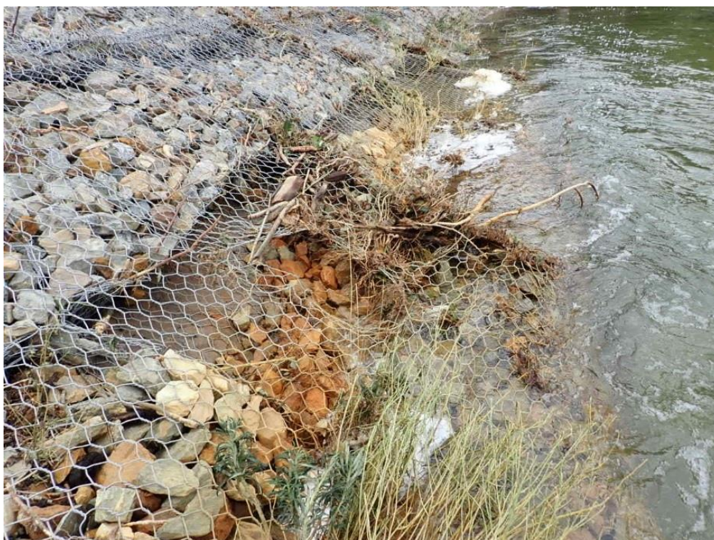
Illustration 57 - Cage de gabions éventrée par la crue (17/10/2018).
