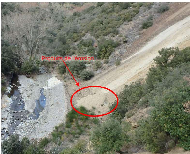
Illustration 52 - Pied de versant et fossé après crue (21/03/2019).
