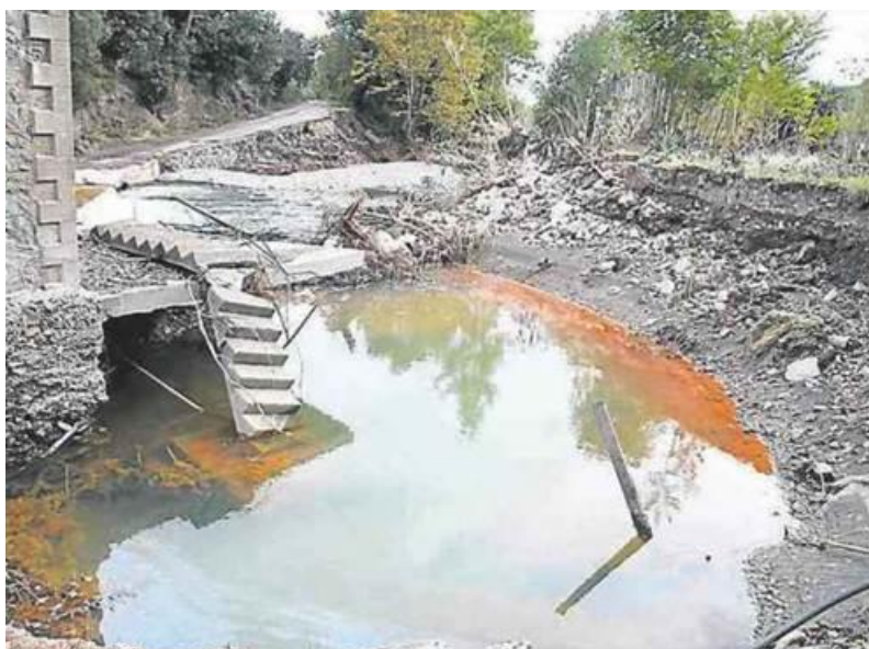
Illustration 34 - Photographie de la mare d'eau stagnante au Gué Lassac et de ses flocs orangés (source : La Dépêche du Midi du 22/01/2019).
