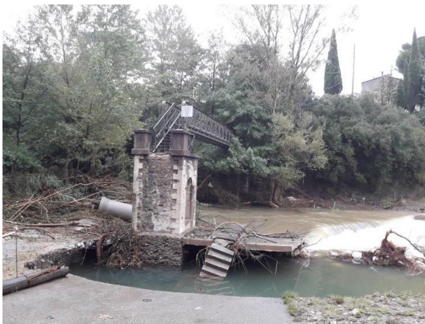
Illustration 33 - Localisation de l'affouillement à proximité de l'Orbiel au Gué Lassac.
