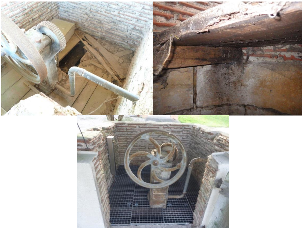
Illustration 48 : Photographies du piézomètre 01894X0002/S1 de Vanault-le-Chatel (51) avant (en haut) et après (en bas) aménagement du site.
