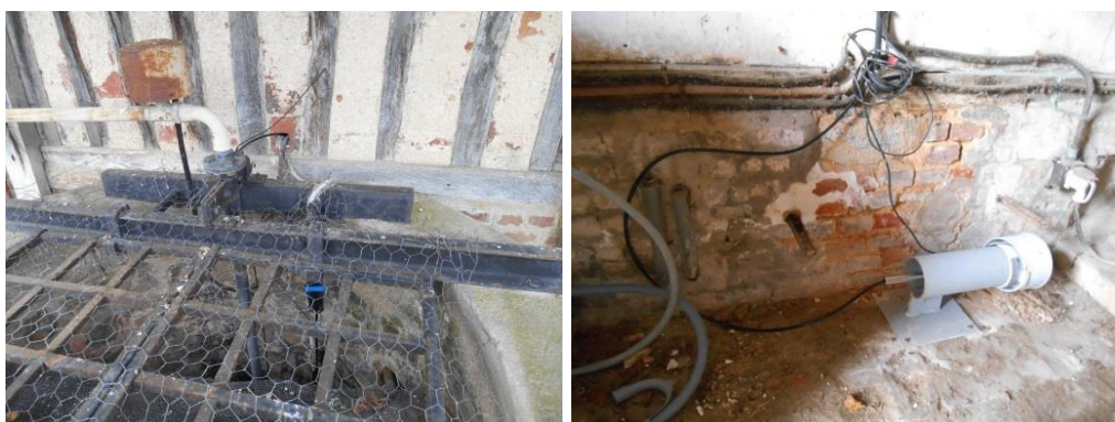
Illustration 59 : Photographies du remplacement du matériel (de la rénovation) de l'ouvrage « 00581X0015/P » d'Ermenouville - 76, avant (en haut) et après (en bas) les travaux.
