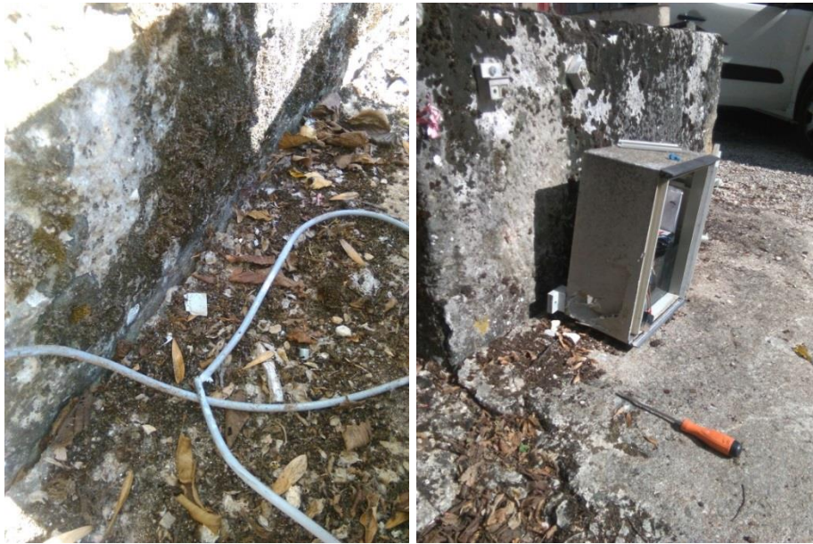
Illustration 18 : Photographies de l'accident sur l'ouvrage de Noyer - 04354X0026/PUITS – 89.
