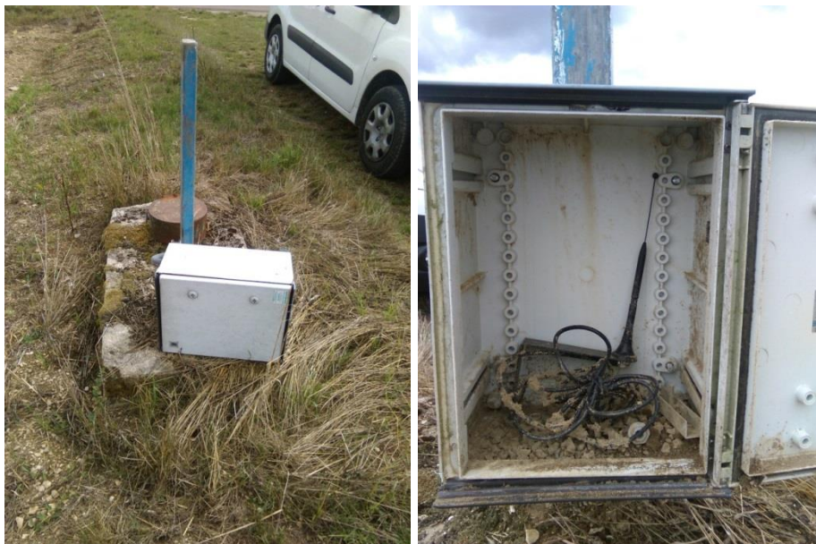
Illustration 19 : Photographies de l'accident sur l'ouvrage de Noyer - 04354X0026 (Yonne).
